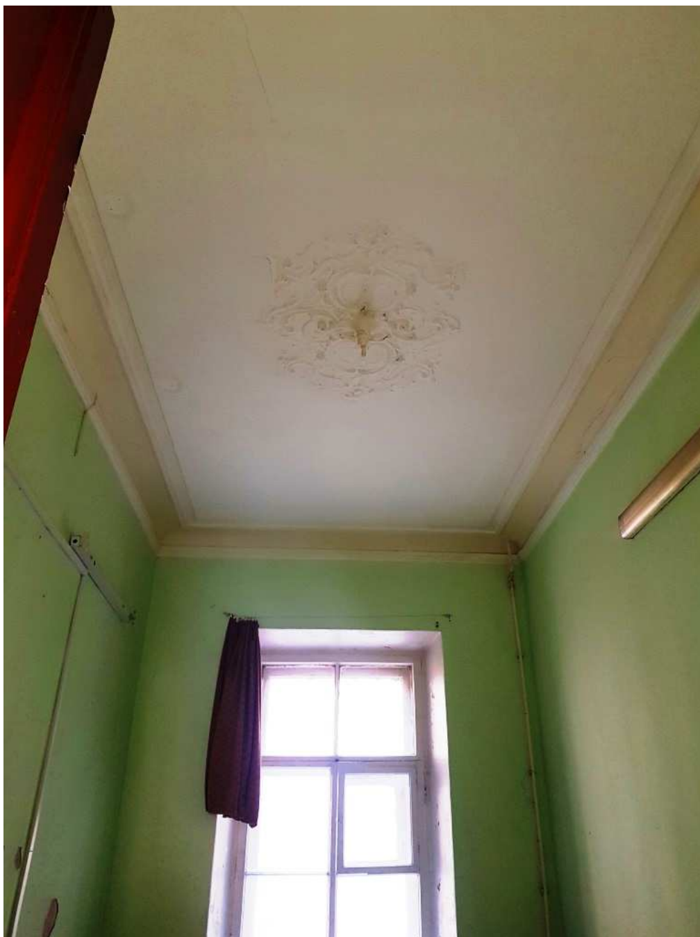
13. Пом. 7. Потолочная розетка.
