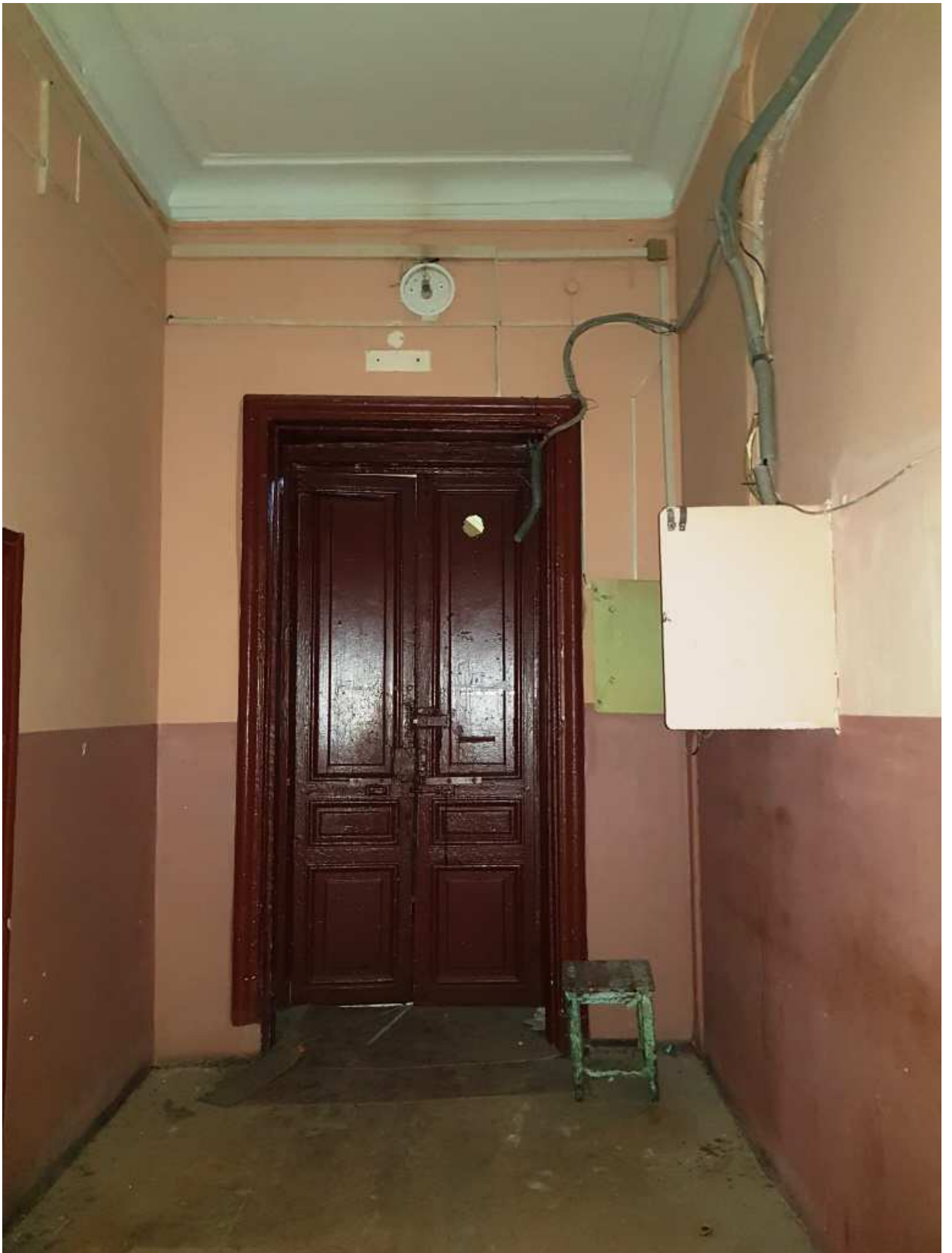
7. Пом.1. Общий вид. Дверное заполнение.
