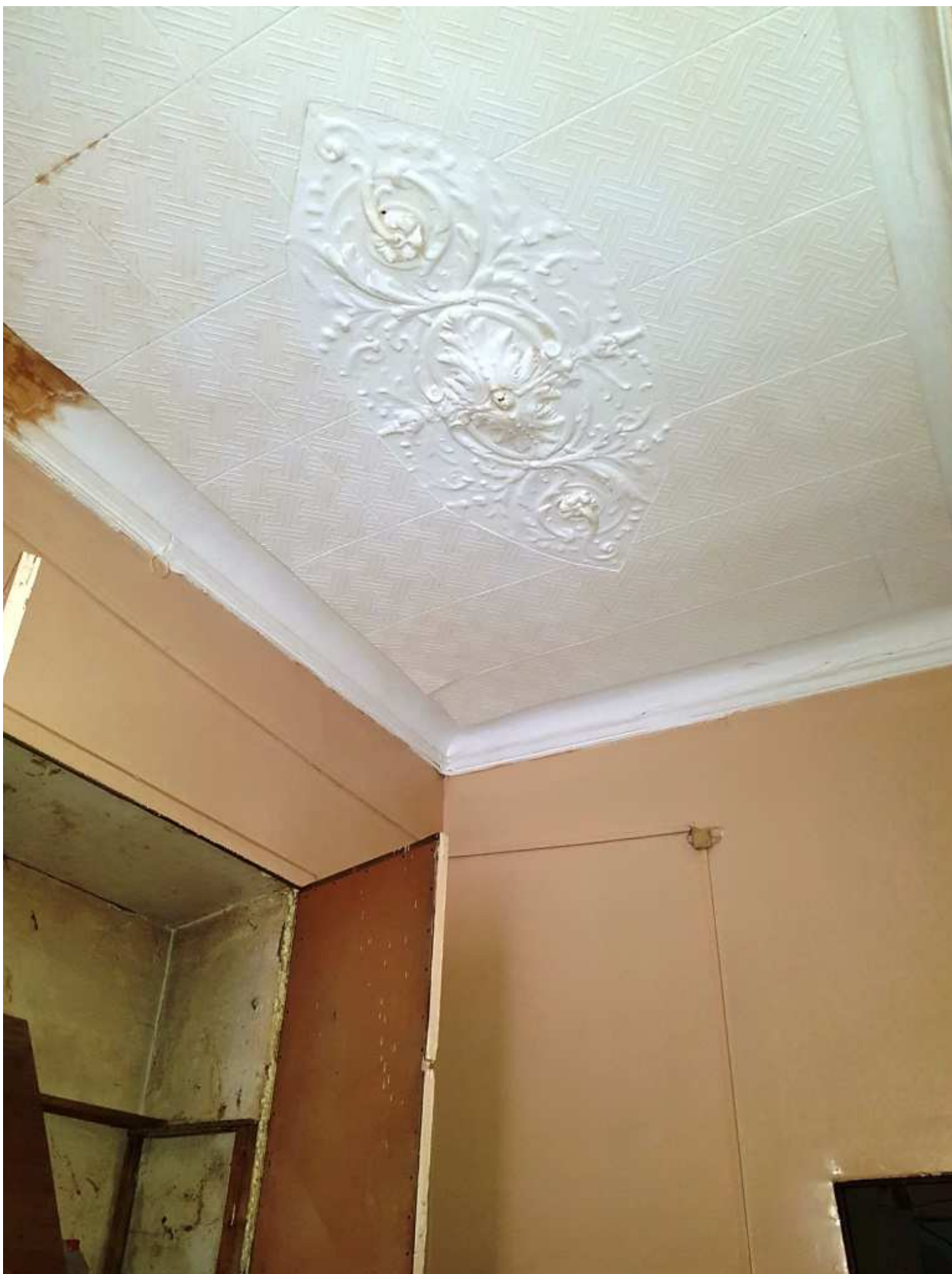
10. Пом.5. Потолочная розетка.
