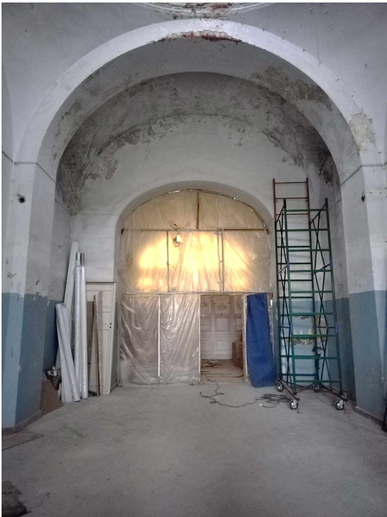
8. Церковный зал. Вид от алтаря в сторону притвора. Поздняя перегородка. Дата съемки: 03.10.2022
