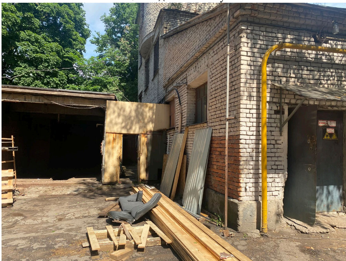
8. Вид на котельную
