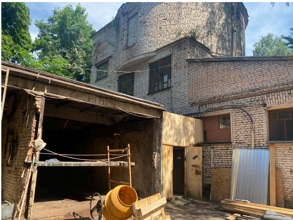
7. Вид на котельную
