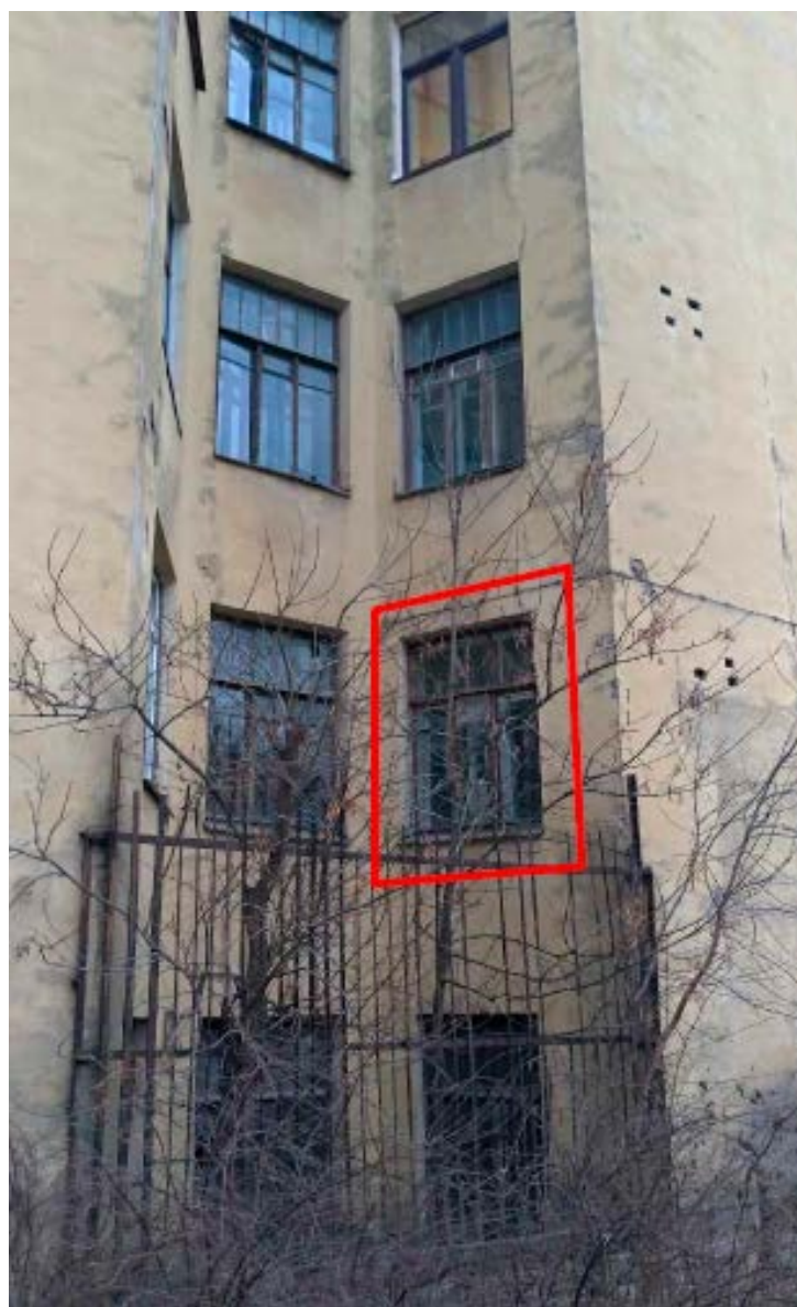
2. Оконное заполнение кв. №2 в уровне 2-го этажа дворового фасада объекта культурного наследия регионального значения «Дом Т.П. Павловой». 05.03.2021.
