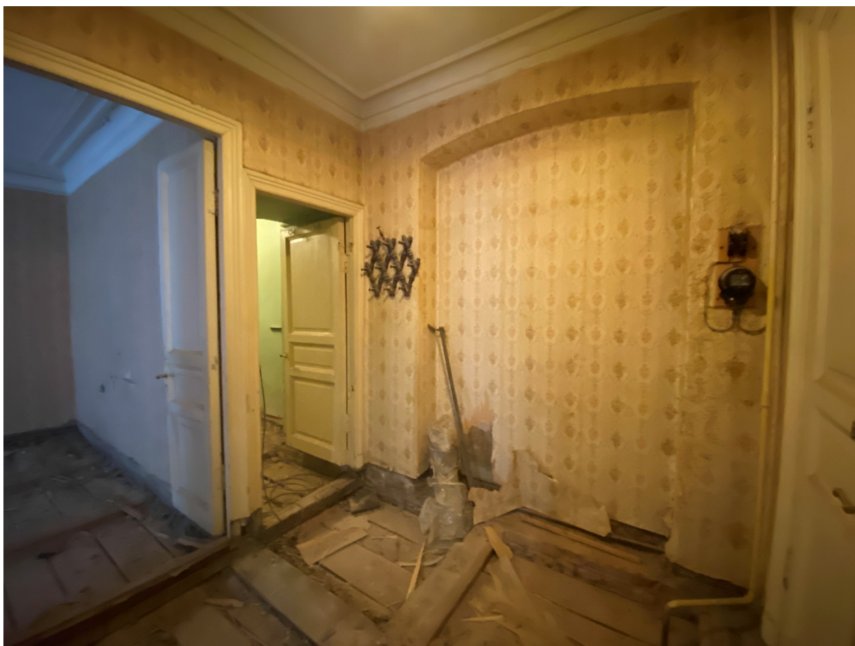
Фото 18. Общий вид помещения № 1 (нумерация помещений указана в соответствии с техническим паспортом по состоянию от 02.12.2019 г. Коридор. Вид с северо-запада.
