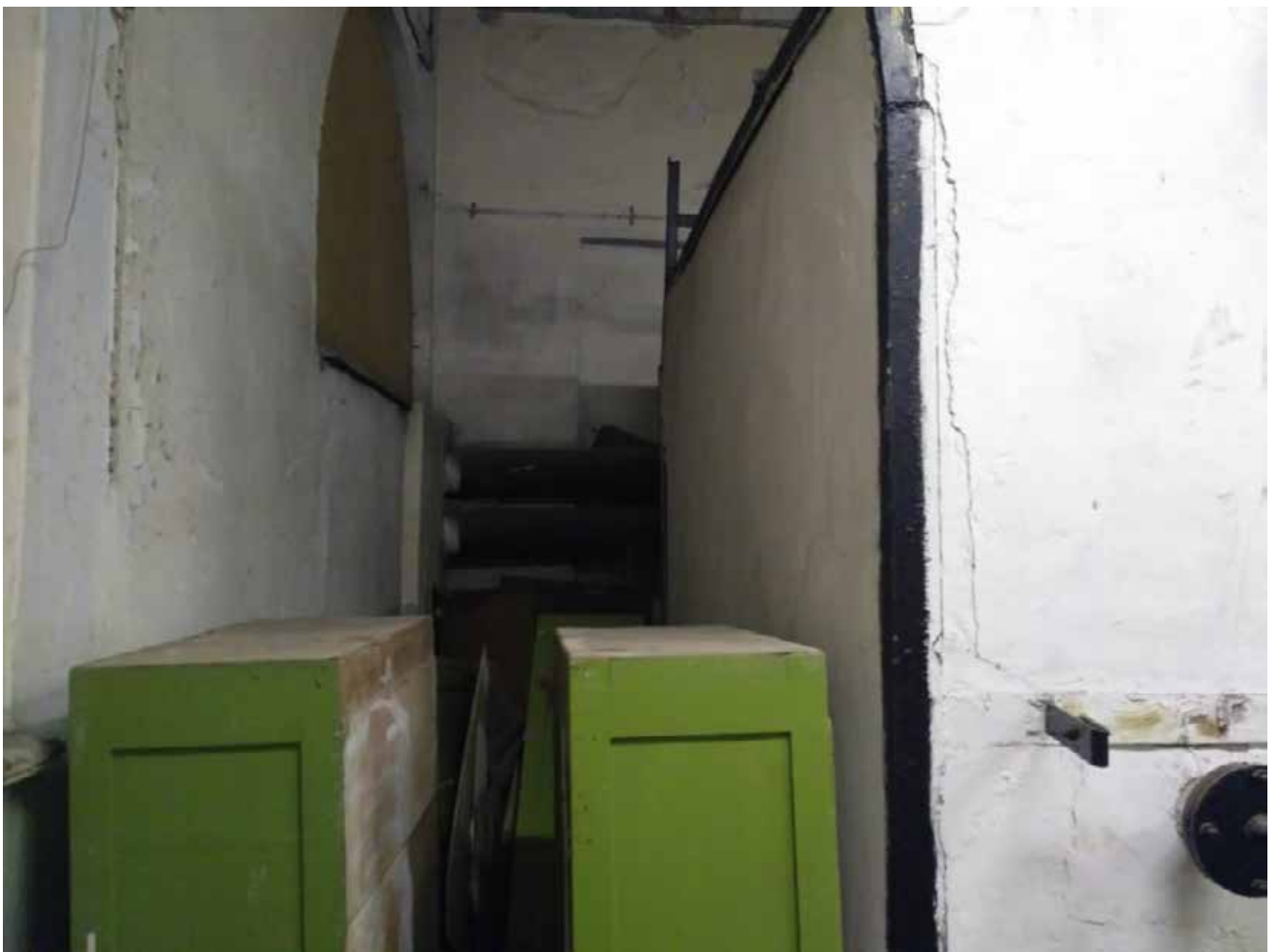
Фото 10. Объект культурного наследия федерального значения "Центральное училище технического рисования и музей Штиглица А.Л" по адресу: Санкт-Петербург, Соляной пер., д. 13-15, лит. А. Помещения 11-Н (Котельная)
