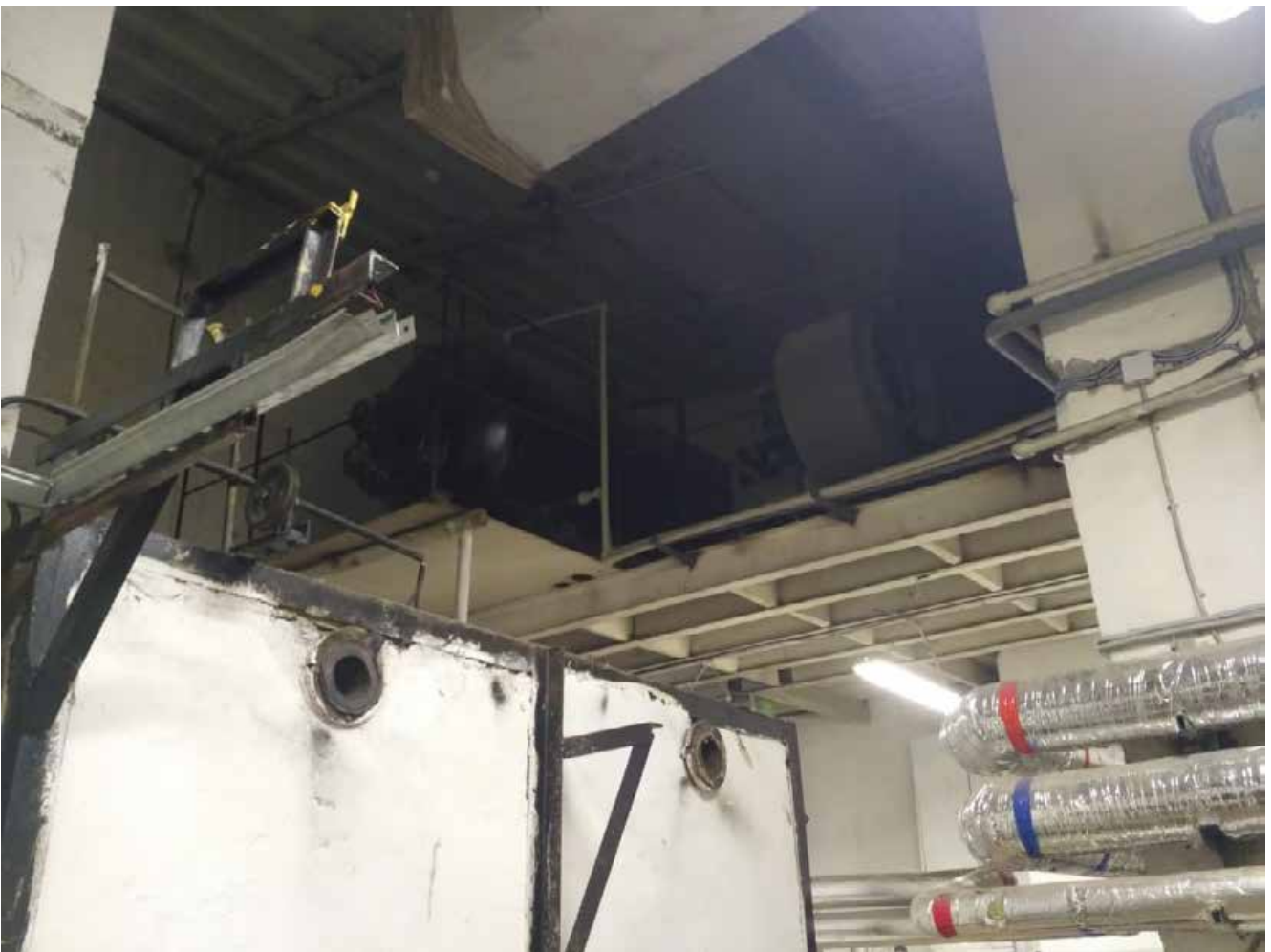
Фото 5. Объект культурного наследия федерального значения "Центральное училище технического рисования и музей Штиглица А.Л" по адресу: Санкт-Петербург, Соляной пер., д. 13-15, лит. А. Помещения 11-Н (Котельная)
