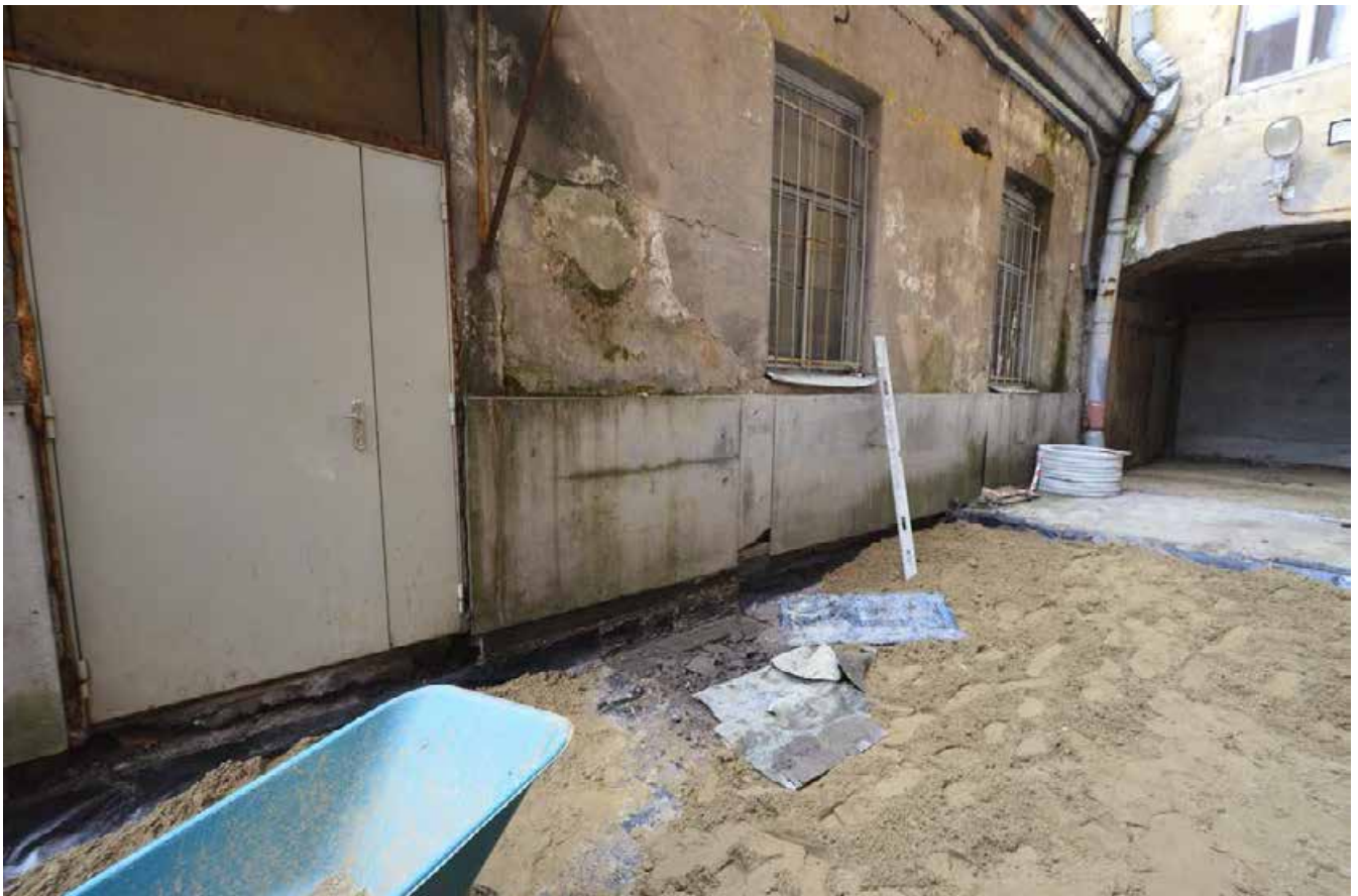
Фото 2. Объект культурного наследия федерального значения "Центральное училище технического рисования и музей Штиглица А.Л" по адресу: Санкт-Петербург, Соляной пер., д. 13-15, лит. А. Помещения 11-Н (Котельная)
