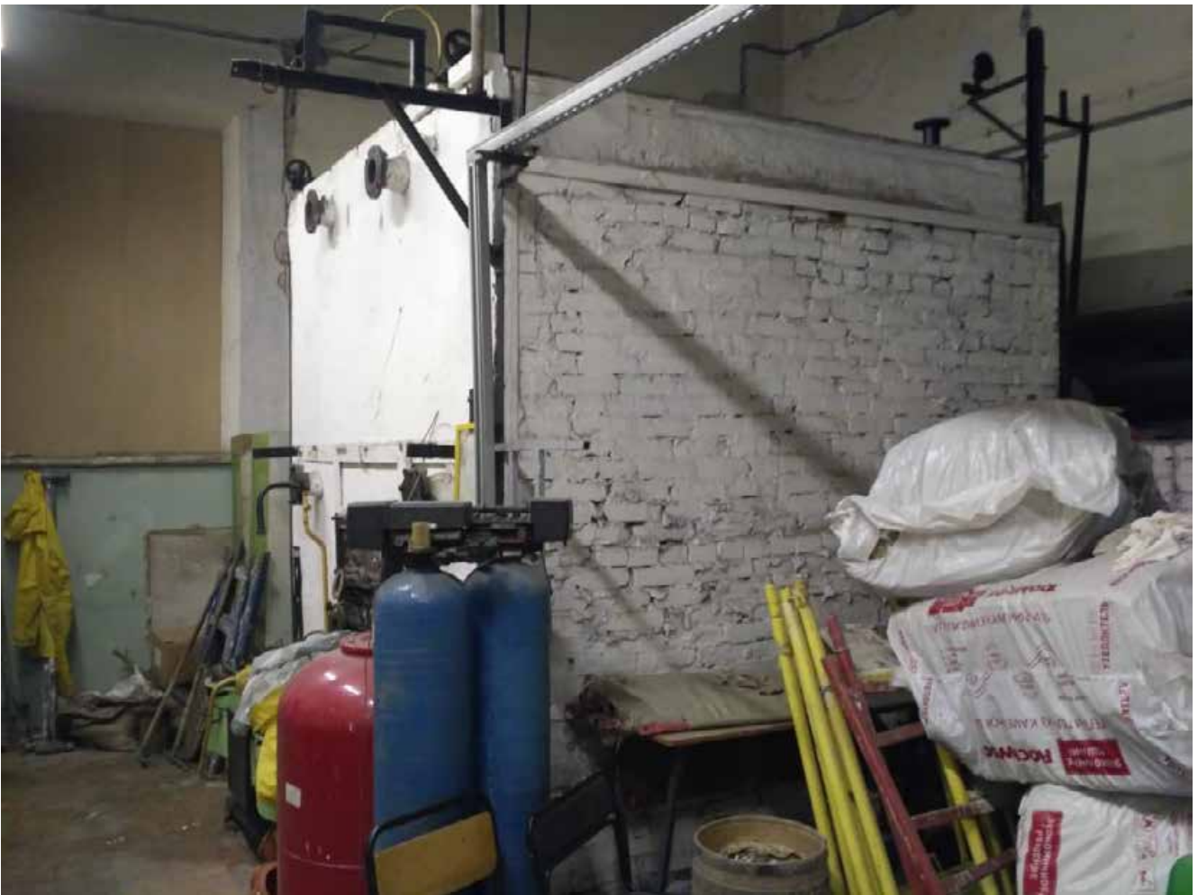
Фото 7. Объект культурного наследия федерального значения "Центральное училище технического рисования и музей Штиглица А.Л" по адресу: Санкт-Петербург, Соляной пер., д. 13-15, лит. А. Помещения 11-Н (Котельная)
