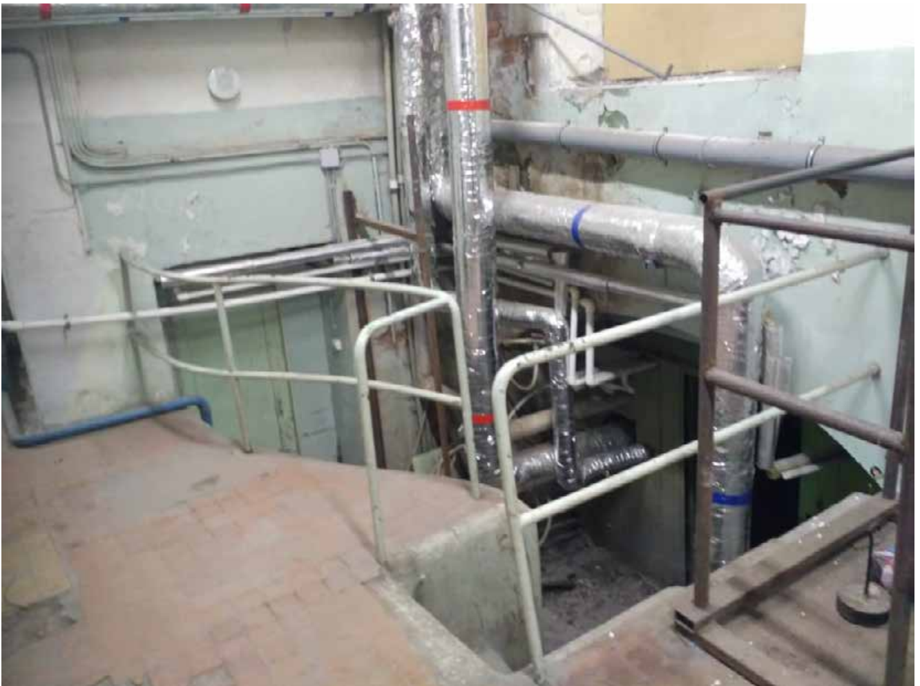
Фото 6. Объект культурного наследия федерального значения "Центральное училище технического рисования и музей Штиглица А.Л" по адресу: Санкт-Петербург, Соляной пер., д. 13-15, лит. А. Помещения 11-Н (Котельная)
