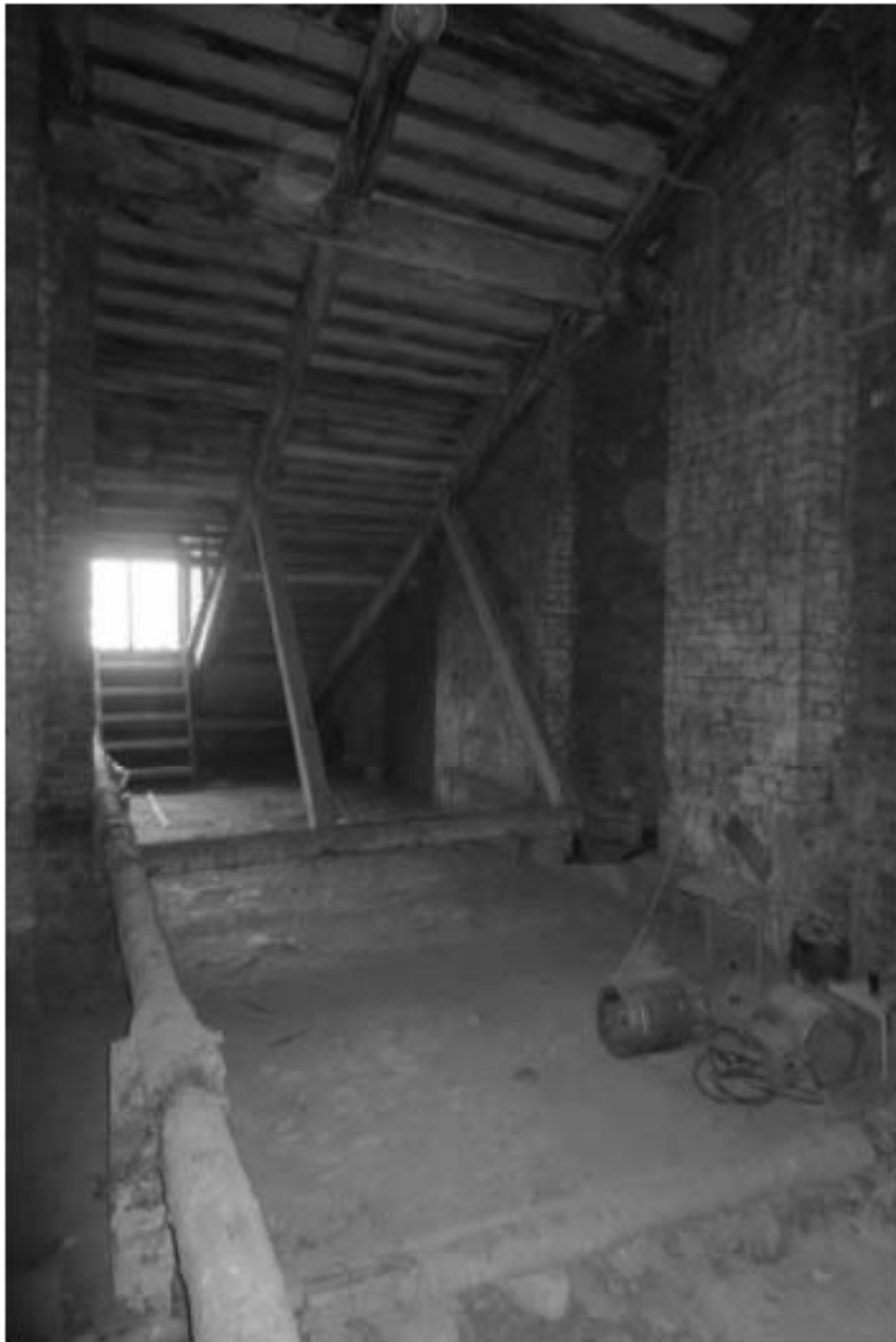
180. «Особняк Безобразовой». Санкт-Петербург, Моховая ул., 34, литера А (Моховая ул., 34). Фрагмент чердачного помещения. Фото: 18.05.2021.
