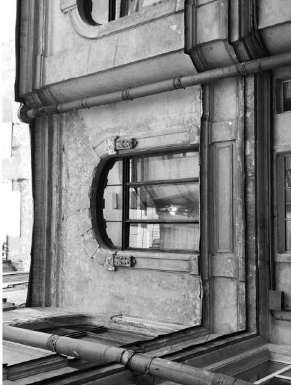
17. «Особняк Безобразовой». Санкт-Петербург, Моховая ул., 34, литера А (Моховая ул., 34). Центральный внутренний двор. Фрагмент южного дворового флигеля. Оформление оконного проема. Фото: 18.05.2021.
