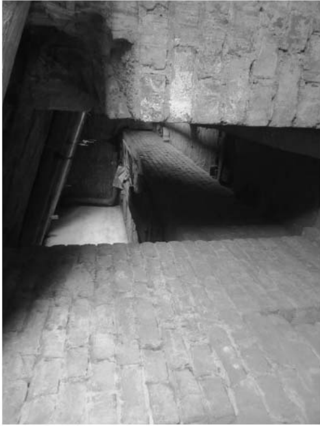
183. «Особняк Безобразовой», Санкт-Петербург, Моховая ул., 34, лигера А (Моховая ул., 34). Фрагмент чердачного помещения. Фото: 18.05.2021.
