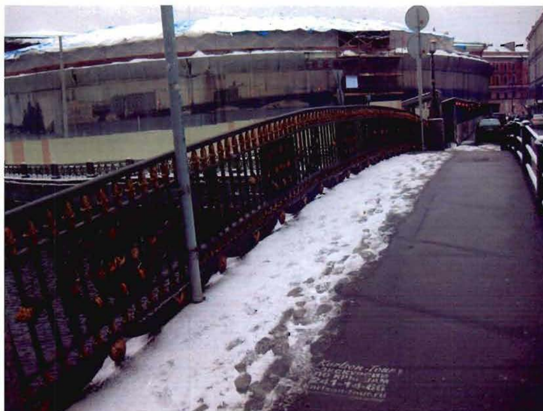
4. Решётка перильного ограждения (утрата красочного слоя и позолоты, коррозия), тротуар со стороны верхового фасада
