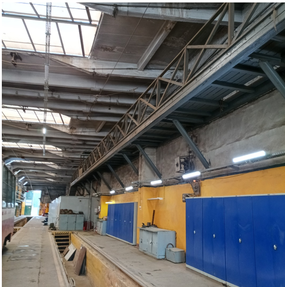
18. Выявленный объект культурного наследия «Депо», по адресу: Санкт-Петербург, Выборгский район, Сердобольская ул., 2г, лит. Д, входящего в состав выявленного объекта культурного наследия «Сооружения Второй очереди городского трамвая», по адресу: Санкт-Петербург, Выборгский район, Сердобольская ул., 2г, лит. Д, Е (Сердобольская ул., 2г.). Фрагмент интерьера. Дата съемки: 05.06.2023г.
