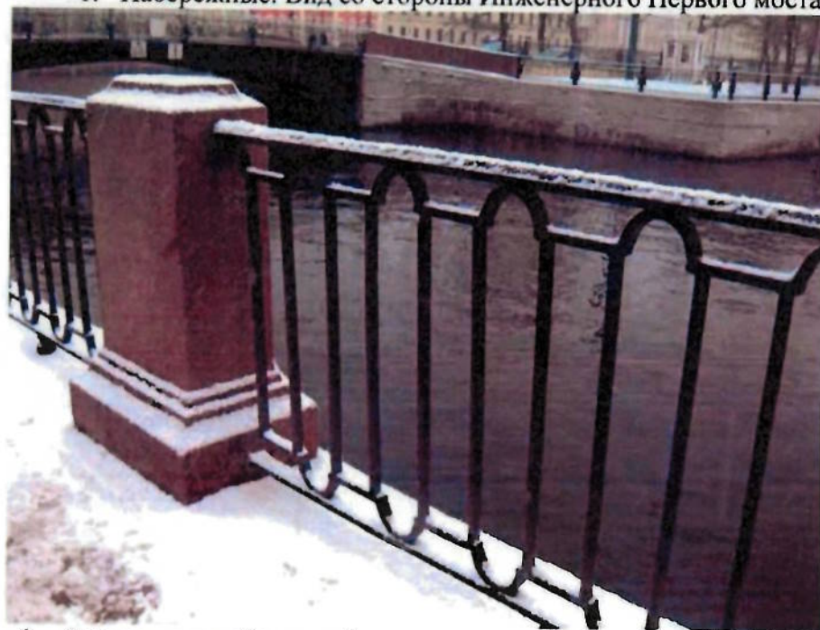
2. Ограждение набережной на участке между Инженерным Первым и Михайловским (1-м Садовым) мостами (правый берег)
