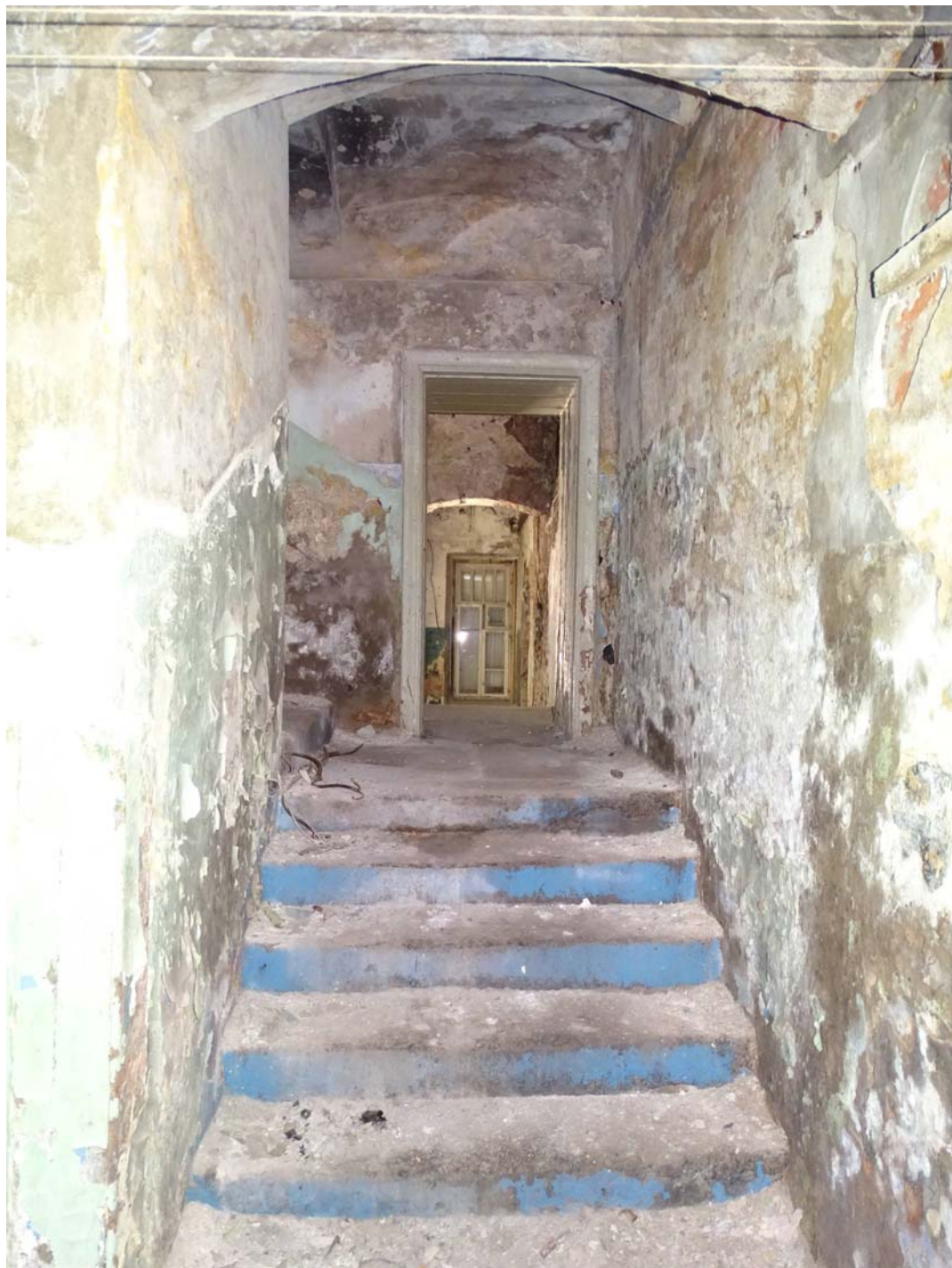
Фото 09. Секция 4. 1-й этаж. Западная лестница. Съемка 15.06.2023 г. Трушковский В.Э.
