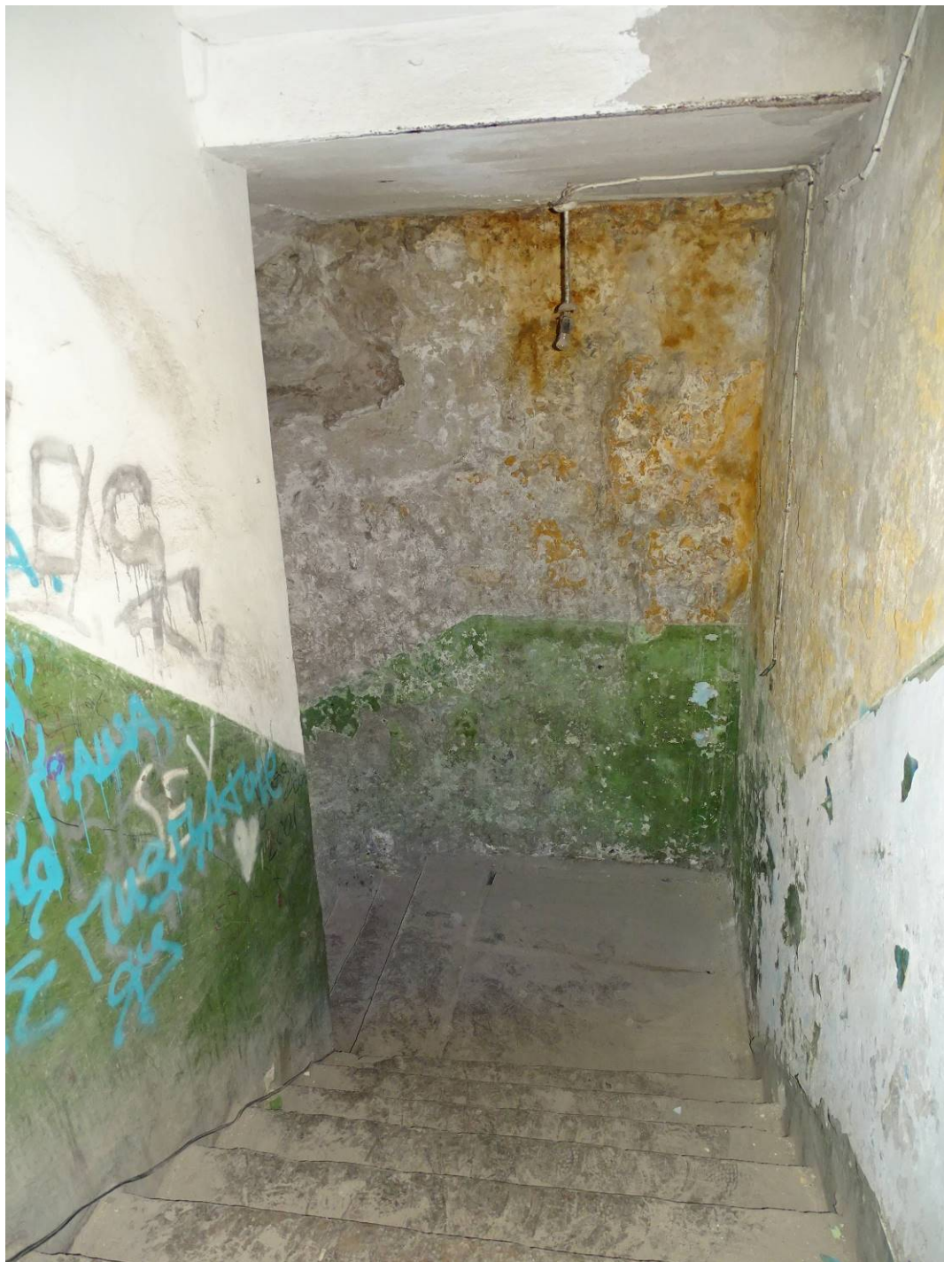
Фото 19. Секция 2. 3-й этаж. Западная лестница. Съемка 15.06.2023 г. Трушковский В.Э.
