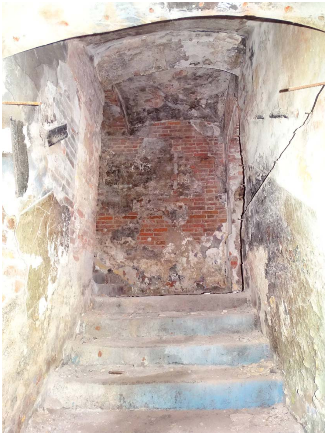
Фото 10. Секция 4. 1-й этаж. Западная лестница. Съемка 15.06.2023 г. Трушковский В.Э.
