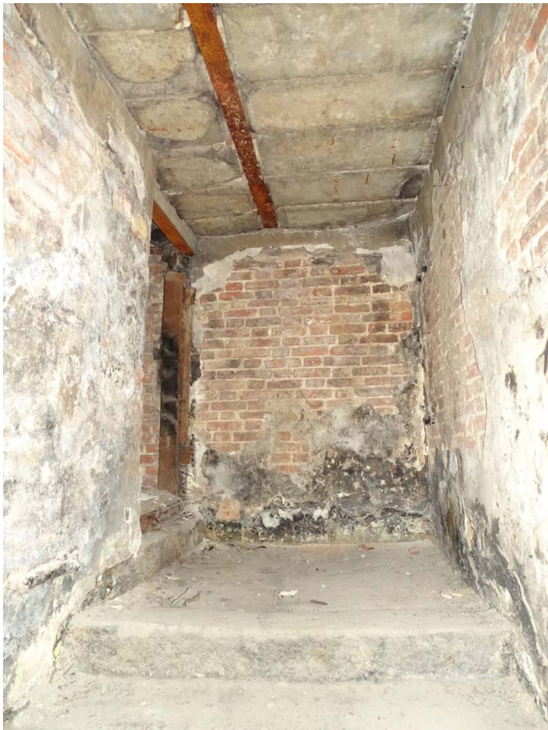
Фото 23. Секция 4. 3-й этаж. Западная лестница. Съемка 15.06.2023 г. Трушковский В.Э.
