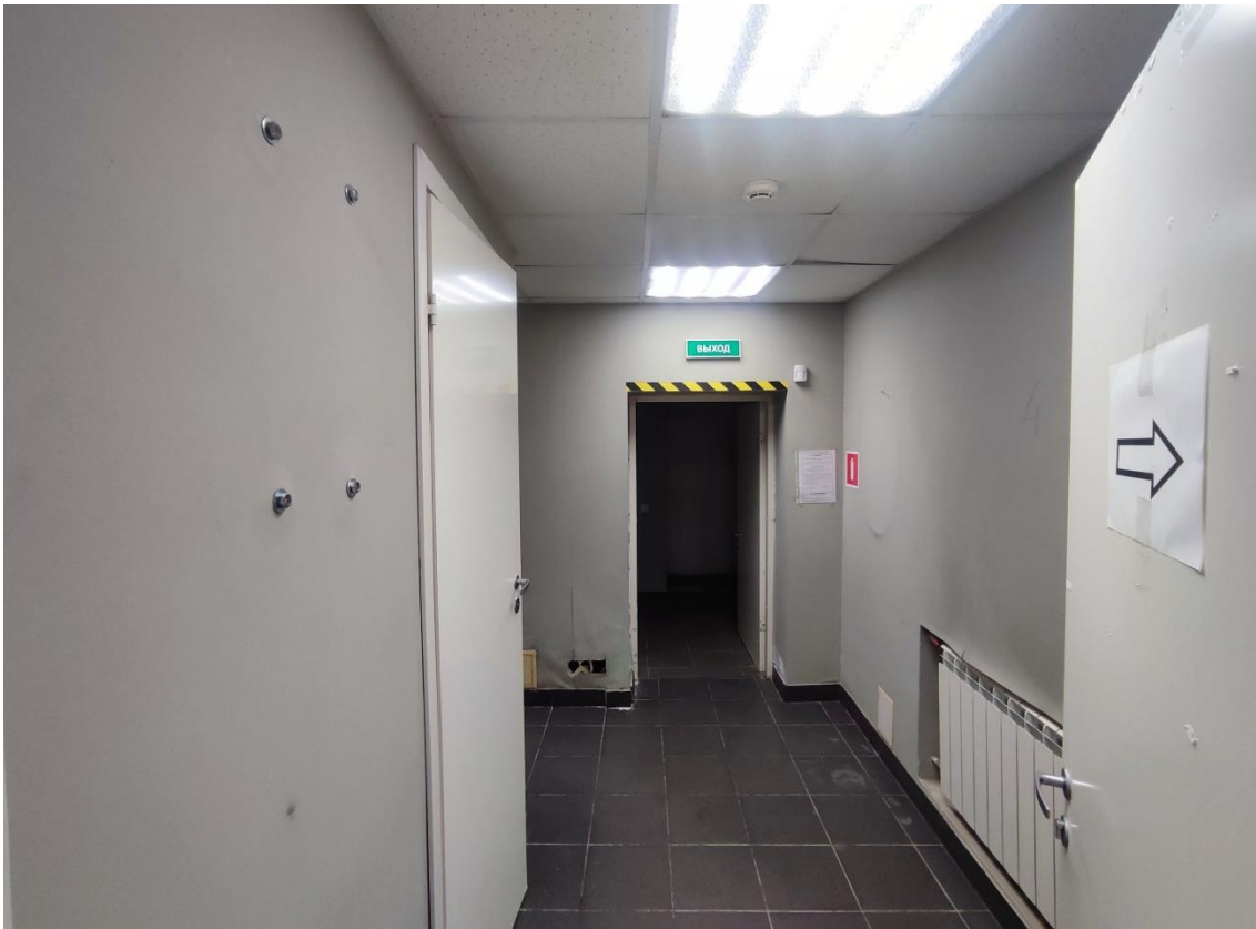
14. Объект культурного наследия регионального значения «Жилой дом купчихи Улановой», расположенный по адресу: Санкт-Петербург, город Кронштадт, проспект Ленина, дом 18, литера А. Фрагмент пом. 1-Н (5) в уровне 1-го этажа.
