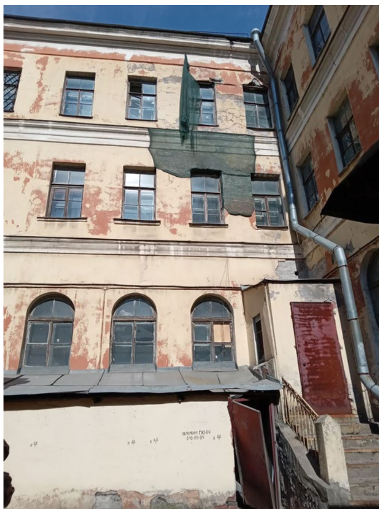
Фото 23. Выявленный объект культурного наследия «Здание детского приюта вел. кн. Александры Николаевны (со служебными постройками)» по адресу: г. Санкт-Петербург, Лермонтовский пр. 51, 12-я Красноармейская б/№
