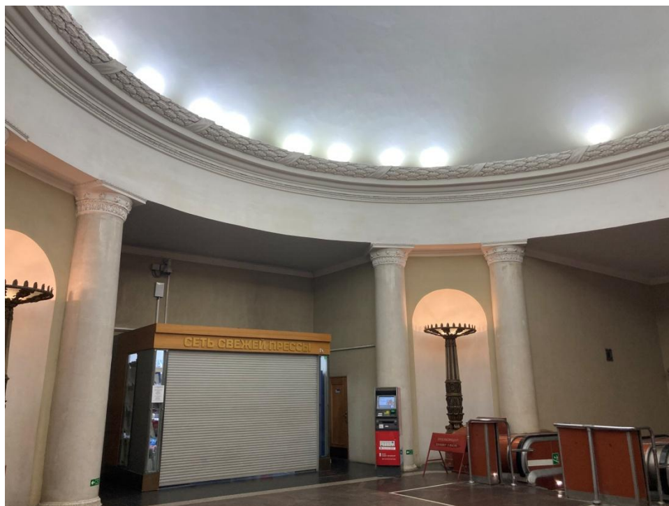
Фото 11 Фрагмент интерьера объекта культурного наследия регионального значения «Станция метро «Кировский завод», г. Санкт-Петербург, пр. Стачек, д. 70, литера А. (распределительный зал) (от 10.07.2023 г.)
