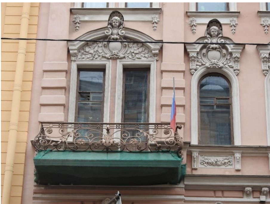
3. «Дом Н.В. Чайковского», ул. Короленко, д. 2, лит. А. Общий вид балкона. Фото 05.04.2023г.
