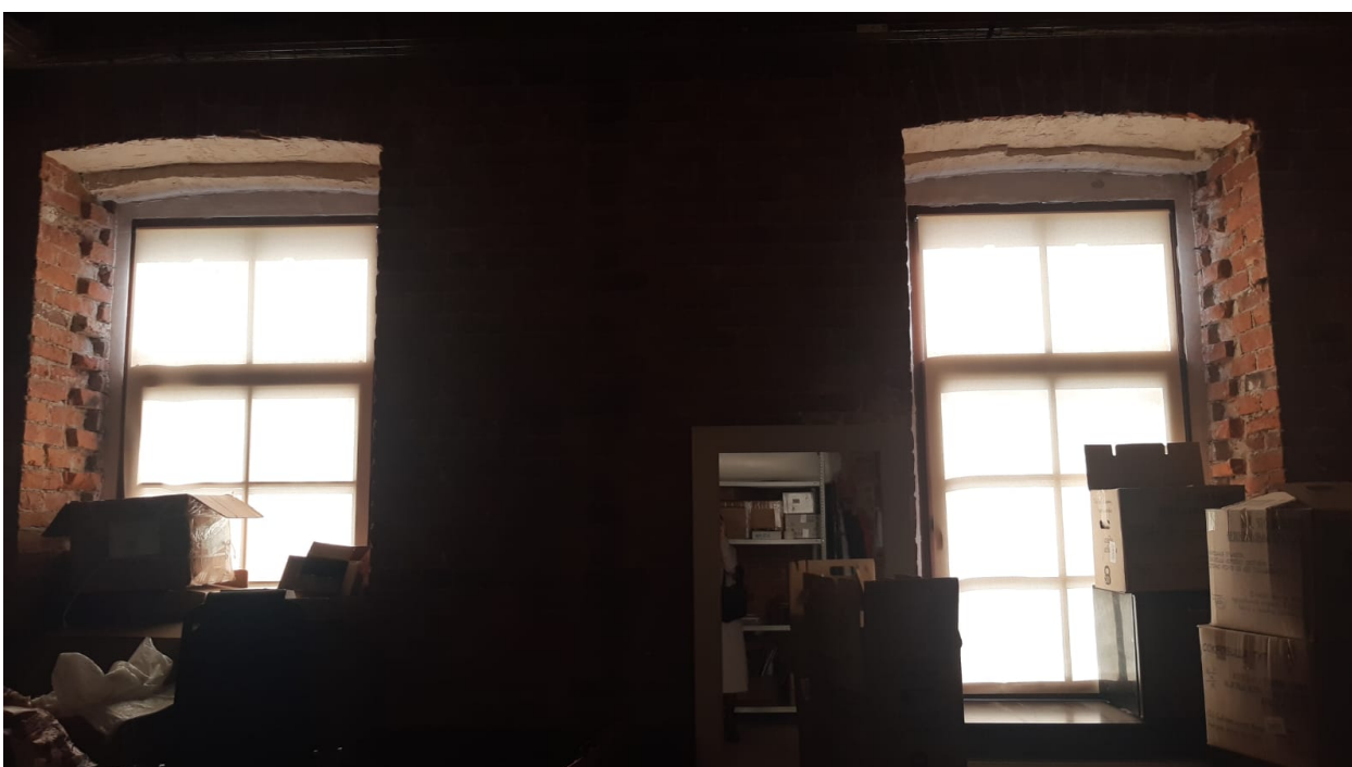
Фото 12. Оконные проемы комнат 23 и 28 в помещении 2-Н. Фото от 02.06.2023 г.
