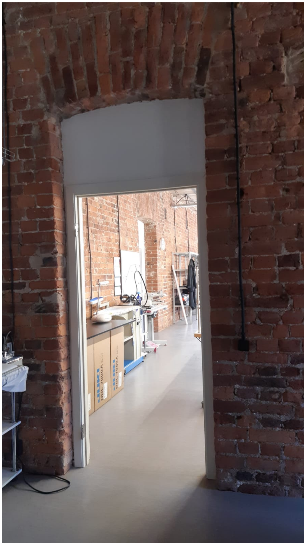
Фото 8. Дверной проем коридора 13 в помещении 2-Н. Фото от 02.06.2023 г.
