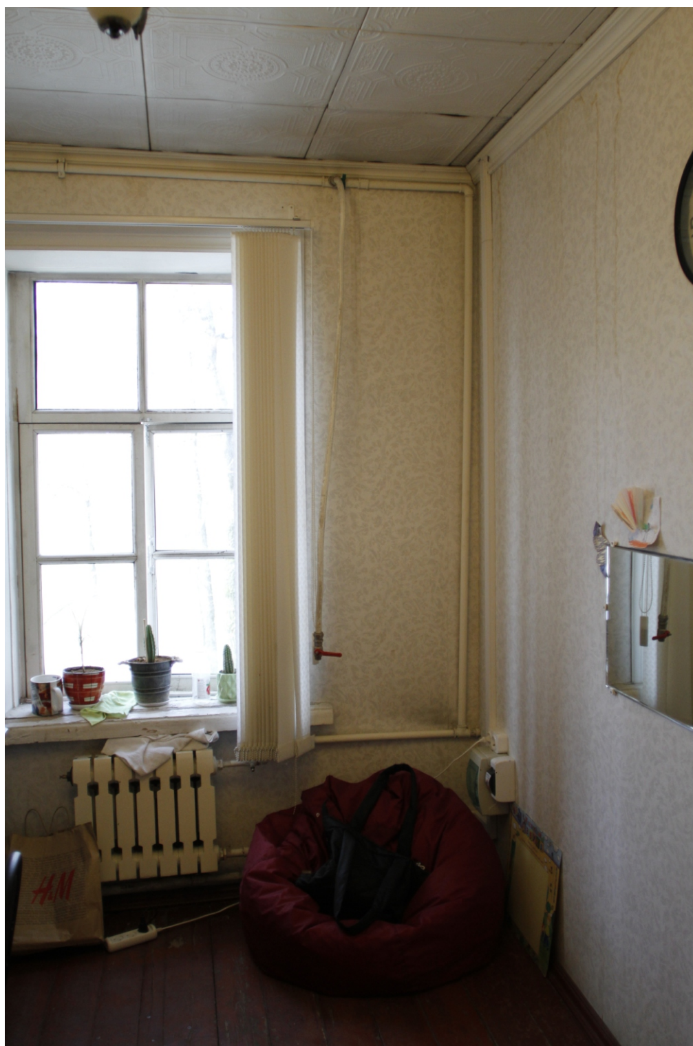
43. «Бывший дворец вел. кн. Михаила Павловича». Санкт-Петербург, г. Красное Село, пр. Ленина, д. 114, литера А. 2 этаж. Фрагмент пом. 9-Н. Фото: 05.05.2023.
