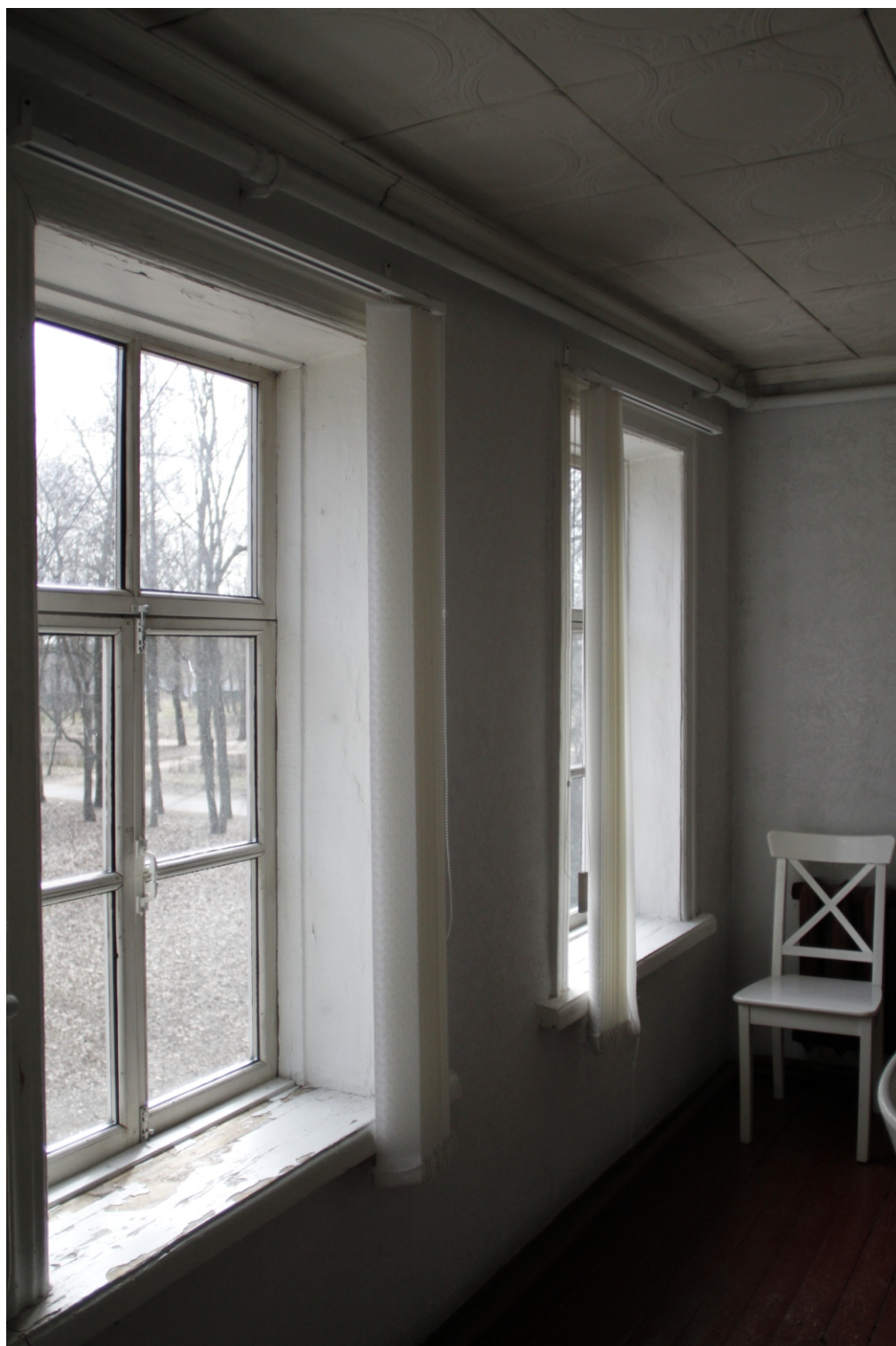
36. «Бывший дворец вел. кн. Михаила Павловича». Санкт-Петербург, г. Красное Село, пр. Ленина, д. 114, литера А. 2 этаж. Фрагмент пом. 16-Н. Фото: 05.05.2023.
