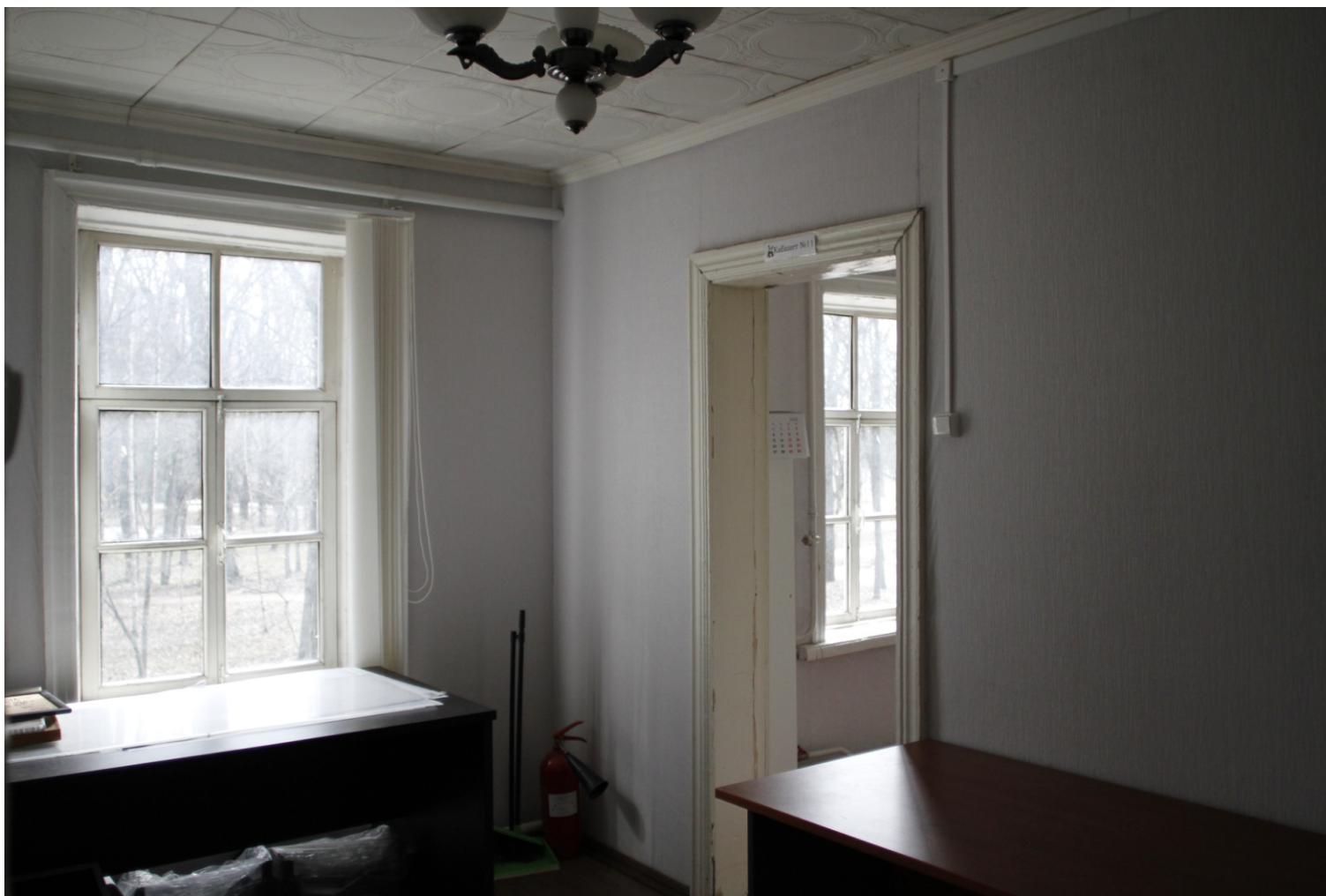
34. «Бывший дворец вел. кн. Михаила Павловича». Санкт-Петербург, г. Красное Село, пр. Ленина, д. 114, литера А. 2 этаж. Фрагмент пом. 3-Н. Фото: 05.05.2023.
