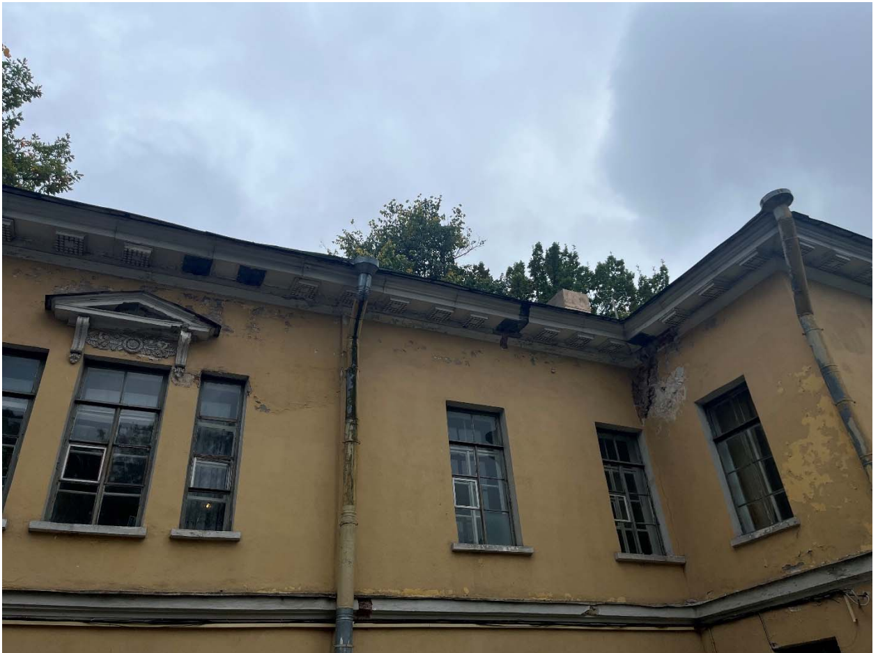
Фото №3. Северный фасад, дефекты в зоне карниза.
