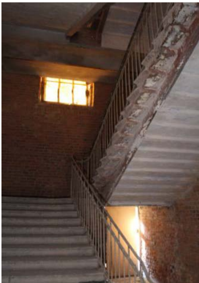
Фото 9. Лестничные марши между 1 и 2 этажами.
