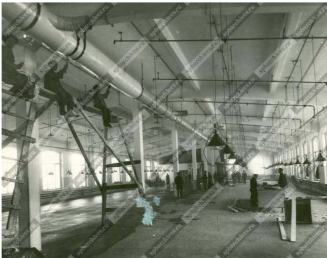
Илл. 78. Работы строительной конторы товарищества «Бодо - Эгесторф и К о » по сооружению фабричного корпуса товарищества «Скорород». 1913 г. ЦГАКФФД Фотодокумент Е 9892. (Южный производственный корпус обувной фабрики в уровне 6-го этажа).
