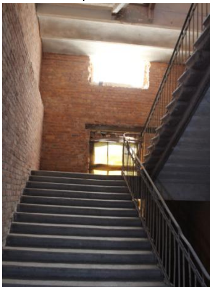
Фото 18. Лестничные марши между 2 и 3 этажами.
