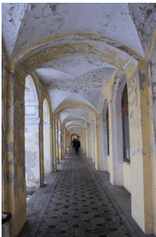
Фото 57. Объект культурного наследия федерального значения «Гостиный двор», по адресу: Санкт-Петербург, г. Пушкин, Московская ул., д. 25; Оранжерейная ул.; Леонтьевская ул. Вид вдоль открытой галереи Гостиного двора со стороны Московской улицы. Дата: 01.12.2021г.
