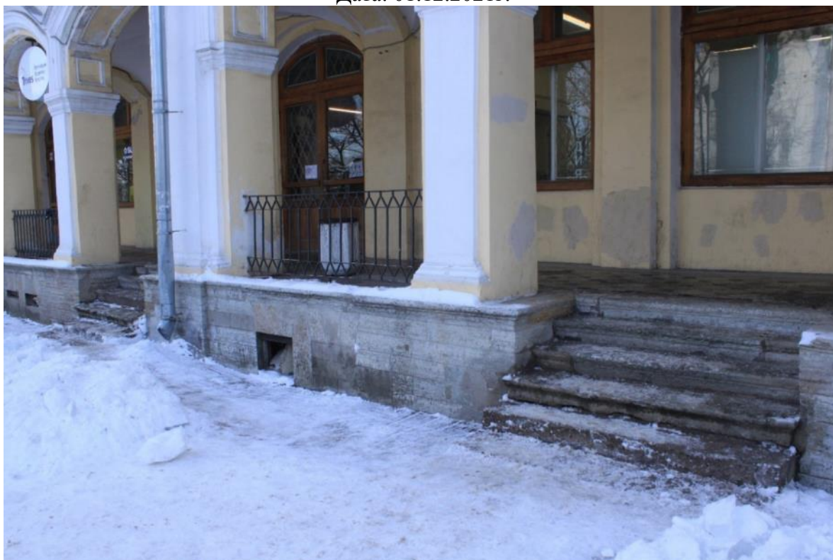
Фото 80. Объект культурного наследия федерального значения «Гостиный двор», по адресу: Санкт-Петербург, г. Пушкин, Московская ул., д. 25; Оранжерейная ул.; Леонтьевская ул. Вид на крыльца Гостиного двора с Московской улицы Дата: 01.12.2021г.
