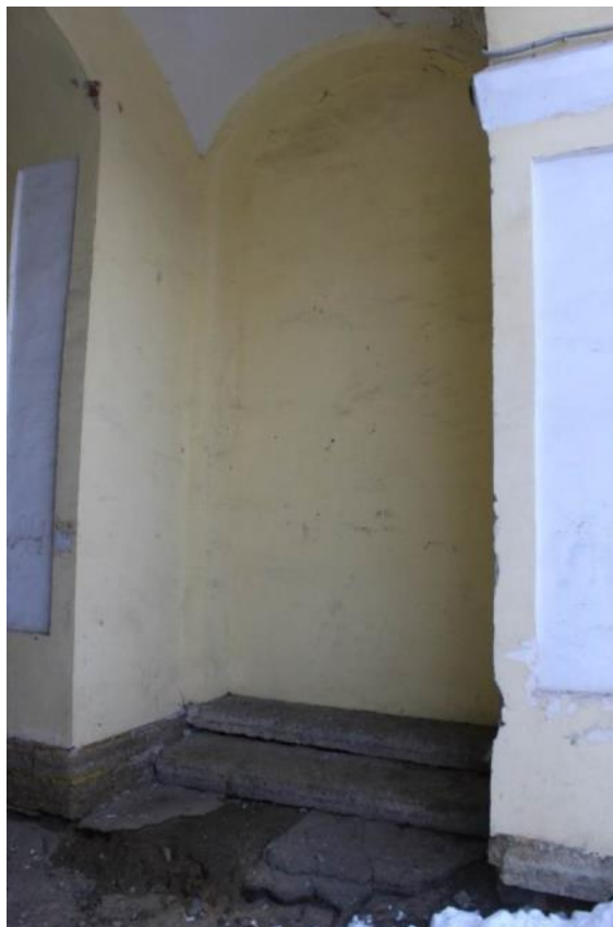
адресу: Санкт-Петербург, г. Пушкин, Московская ул., д. 25; Оранжерейная ул.; Леонтьевская ул. Заложенный проход в арке Гостиного двора с Оранжерейной улицы Дата: 01.12.2021г.
