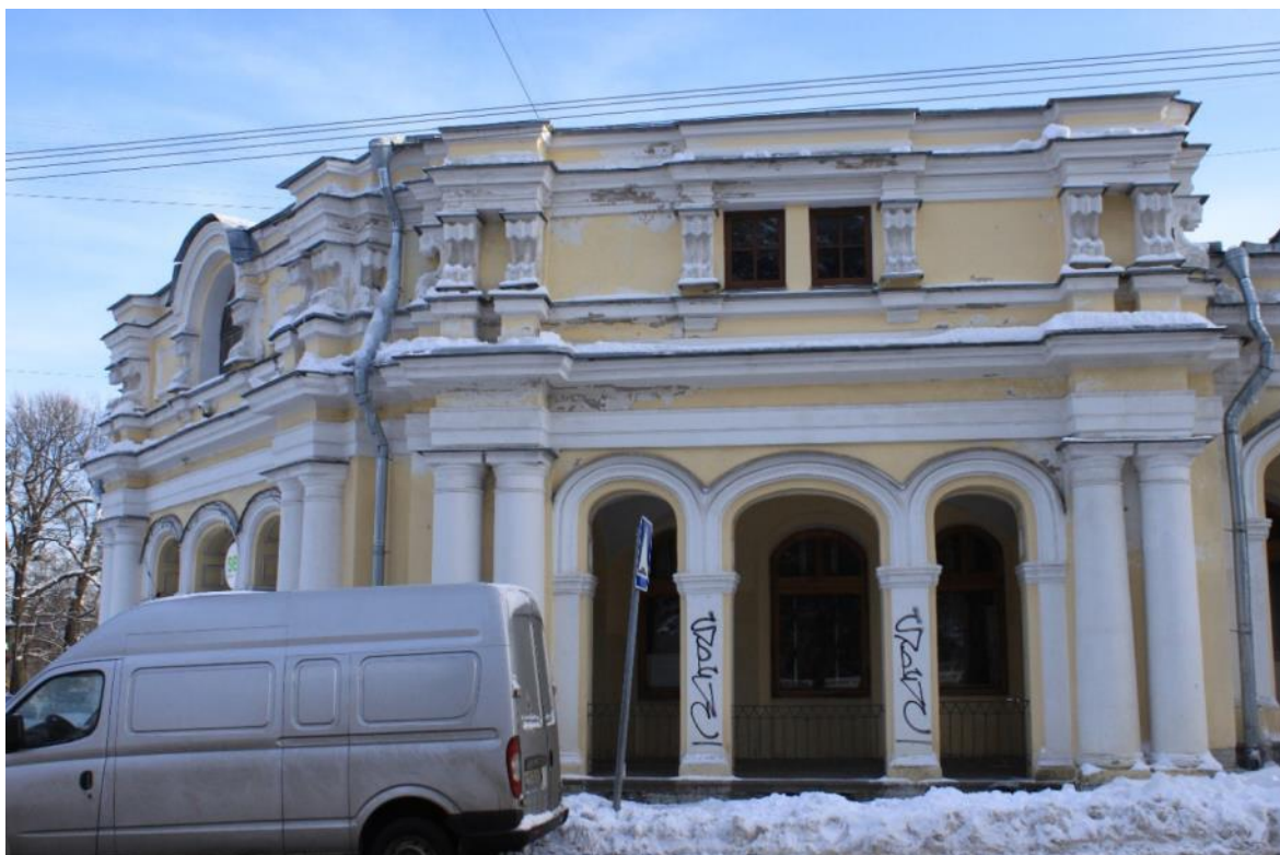
Фото 7. Объект культурного наследия федерального значения «Гостиный двор», по адресу: Санкт-Петербург, г. Пушкин, Московская ул., д. 25; Оранжерейная ул.; Леонтьевская ул. Фрагмент фасада Гостиного двора с Леонтьевской улицы Дата: 01.12.2021г.
