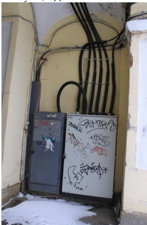
Фото 44. Объект культурного наследия федерального значения «Гостиный двор», по адресу: Санкт-Петербург, г. Пушкин, Московская ул., д. 25; Оранжерейная ул.; Леонтьевская ул. Заложенный проход в арке Гостиного двора со стороны Леонтьевской улицы. Дата: 01.12.2021г.
