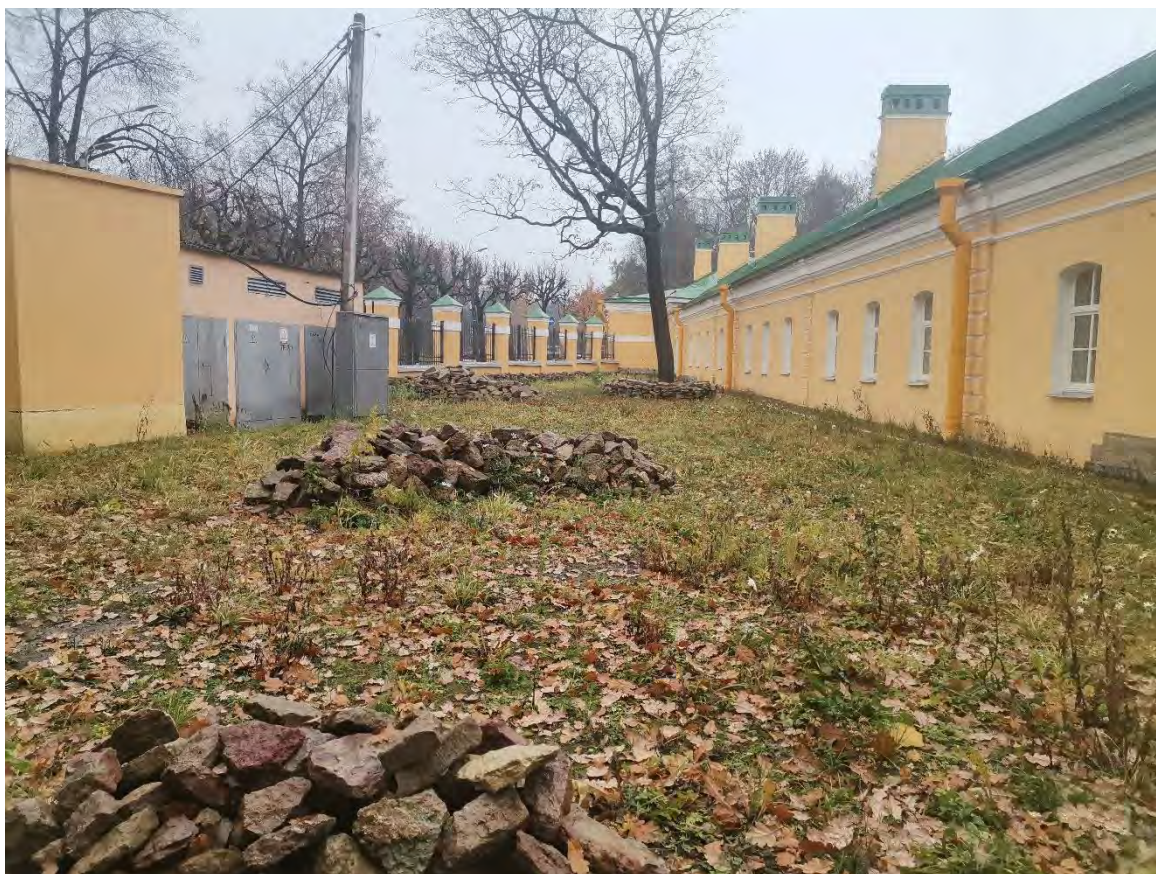
Фото 04. Объекты культурного наследия федерального значения «Флигель жилой» и «Палисадник с оградой». Общий вид. Съёмка 31.10.2022 г.
