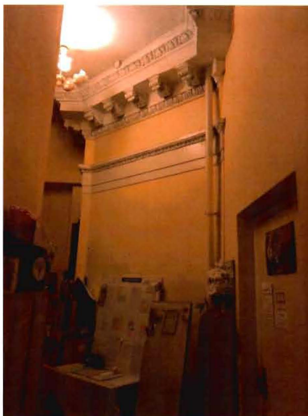
10. Внутренняя планировочная структура объекта культурного наследия. Лепной декор в помещении церковного зала.
