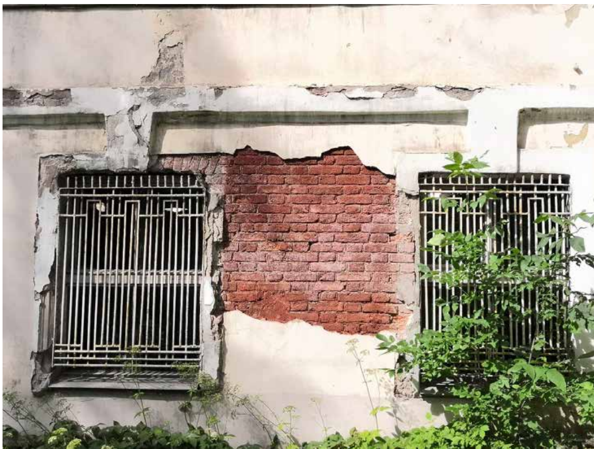
Илл. 9. Вид на фрагмент оголившейся кирпичной кладки лицевого фасада. Адрес: Санкт-Петербург, ул. Дудко, д. 3, лит. ВЯ.
