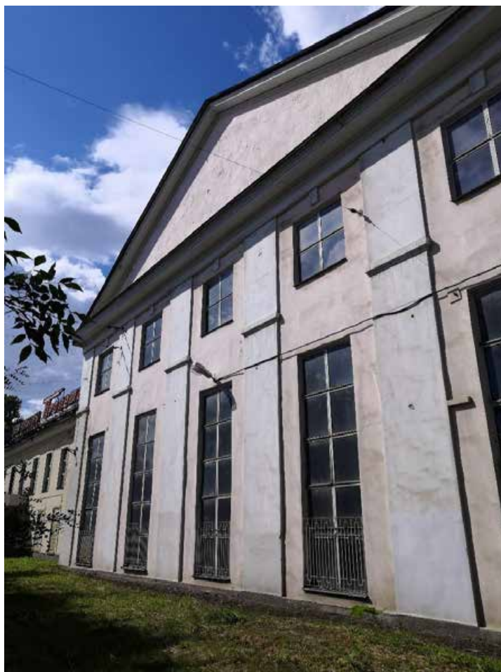
Илл. 15. Вид на фрагмент лицевого фасада с северо-востока. Адрес: Санкт-Петербург, ул. Дудко, д. 3, лит. ВЯ.
