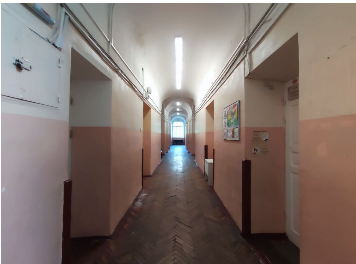
101. Объект культурного наследия регионального значения «Реальное училище», расположенный по адресу: Санкт-Петербург, город Пушкин, Госпитальная улица, дом 24, литера А. Общий вид пом. 1-Н (58) в уровне 2-го этажа.
