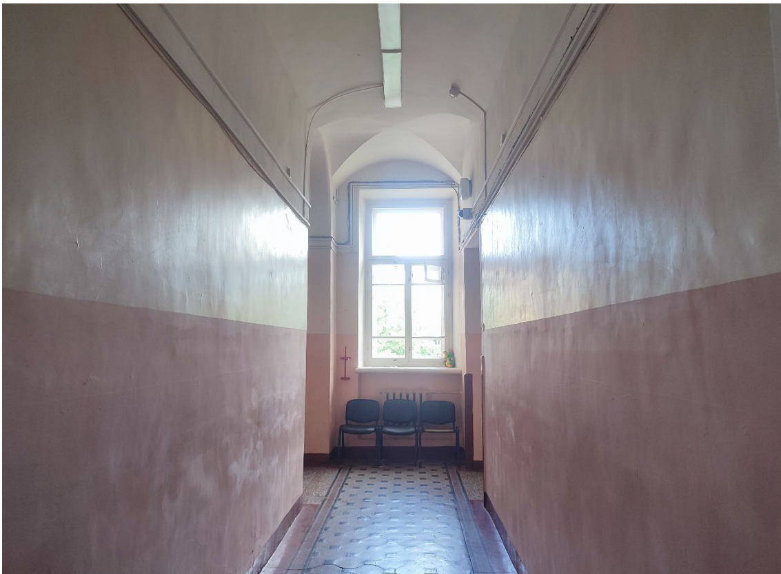
99. Объект культурного наследия регионального значения «Реальное училище», расположенный по адресу: Санкт-Петербург, город Пушкин, Госпитальная улица, дом 24, литера А. Общий вид пом. 1-Н (57) в уровне 2-го этажа.
