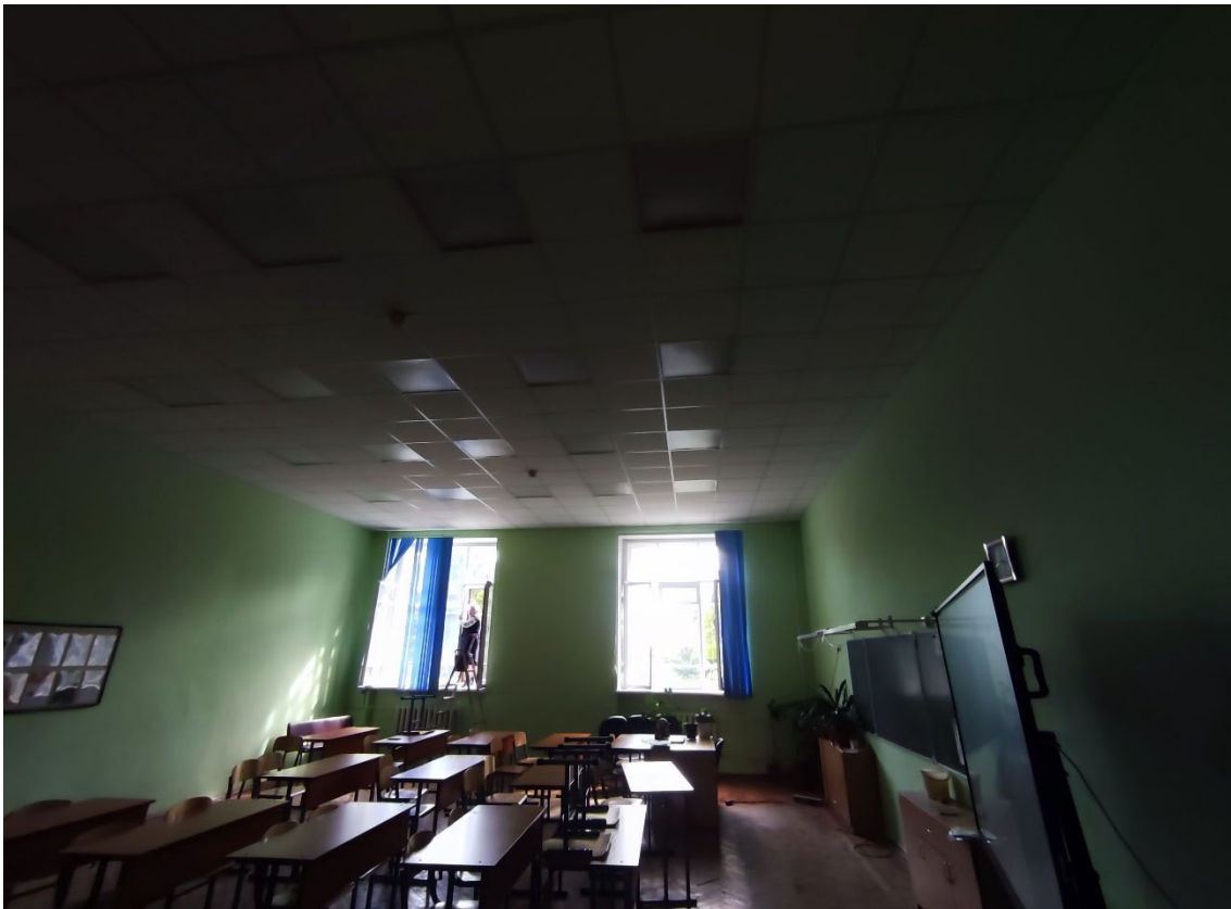
80. Объект культурного наследия регионального значения «Реальное училище», расположенный по адресу: Санкт-Петербург, город Пушкин, Госпитальная улица, дом 24, литера А. Общий вид пом. 1-Н (71) в уровне 2-го этажа.
