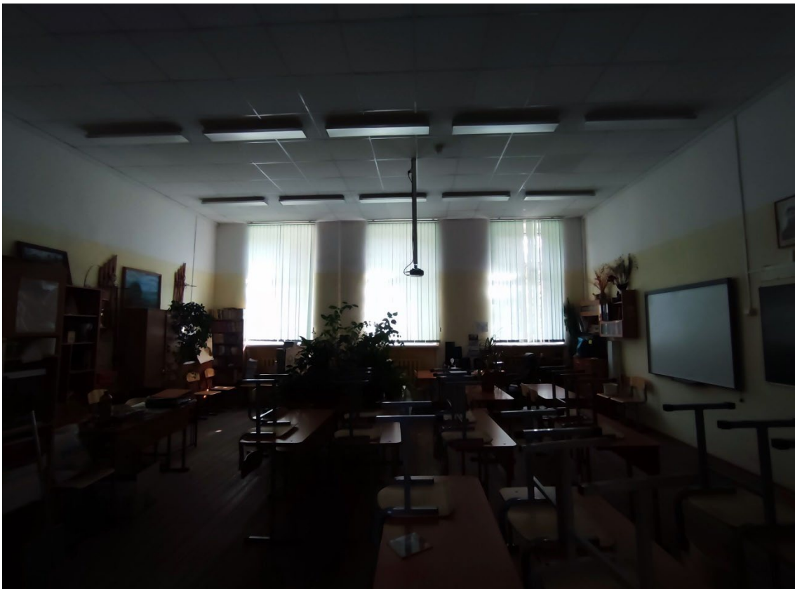
97. Объект культурного наследия регионального значения «Реальное училище», расположенный по адресу: Санкт-Петербург, город Пушкин, Госпитальная улица, дом 24, литера А. Общий вид пом. 1-Н (67) в уровне 2-го этажа.
