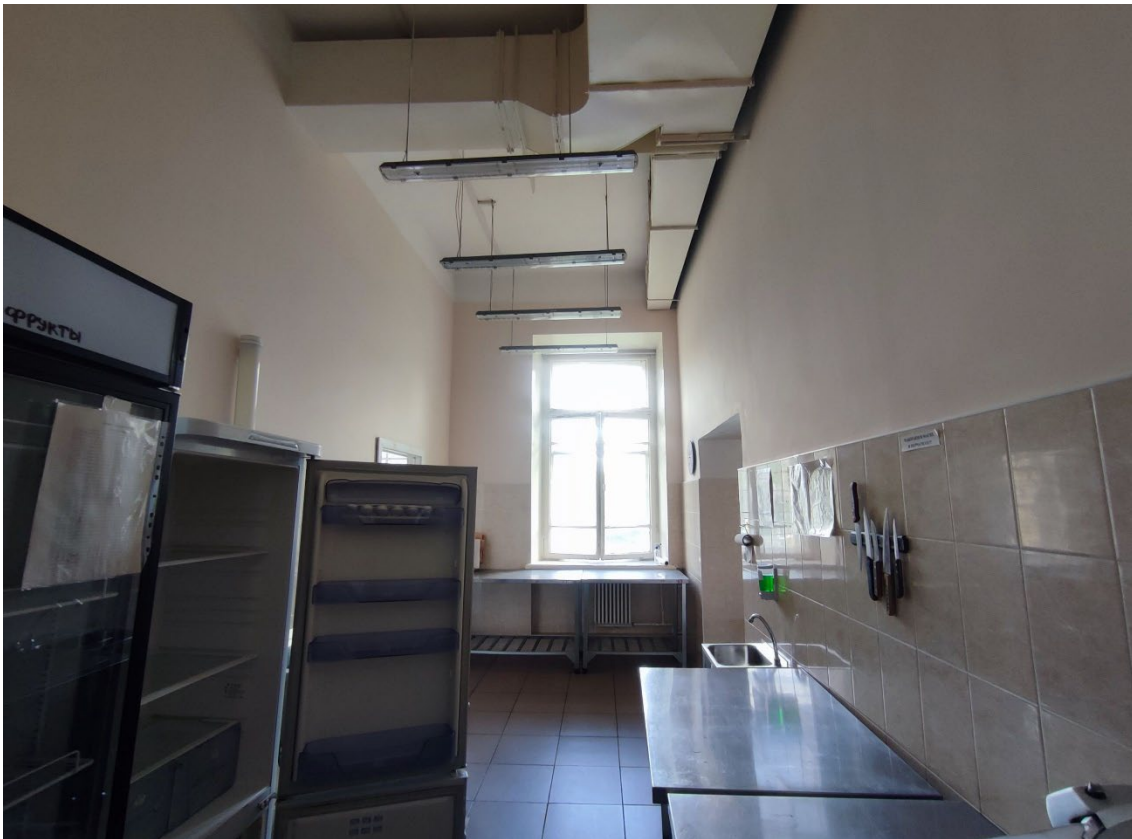
56. Объект культурного наследия регионального значения «Реальное училище», расположенный по адресу: Санкт-Петербург, город Пушкин, Госпитальная улица, дом 24, литера А. Фрагмент пом. 1-Н (45) в уровне 1-го этажа.
