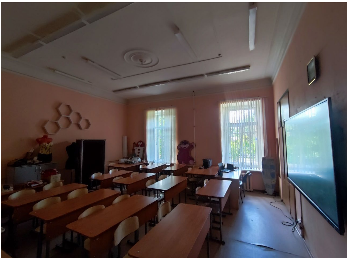
87. Объект культурного наследия регионального значения «Реальное училище», расположенный по адресу: Санкт-Петербург, город Пушкин, Госпитальная улица, дом 24, литера А. Общий вид пом. 1-Н (77) в уровне 2-го этажа.
