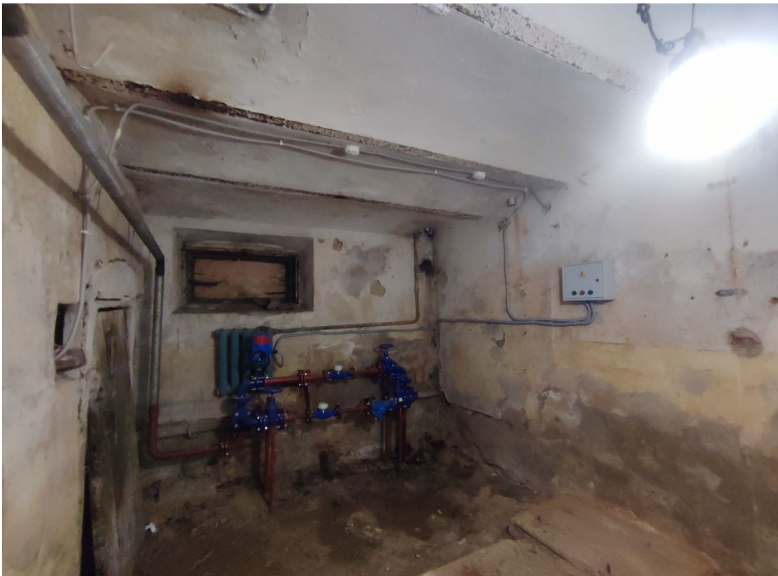
10. Объект культурного наследия регионального значения «Реальное училище», расположенный по адресу: Санкт-Петербург, город Пушкин, Госпитальная улица, дом 24, литера А. Общий вид пом. 1-Н (172) в уровне подвала.
