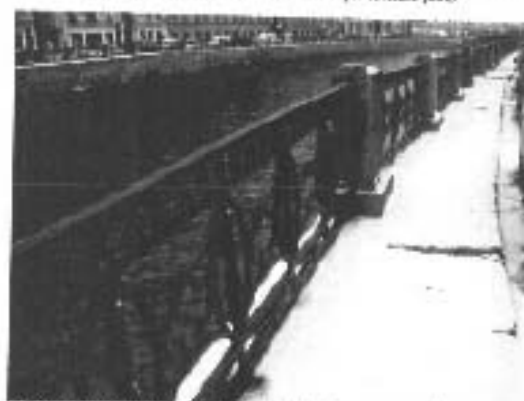
12. Правильное ограждение, тротуар (правый берег) по участку моста Пискаревского и Голландского (Коллежский Нарвский мост)
