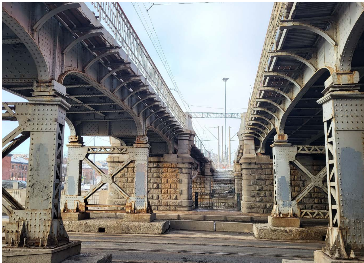
Фото 19. Объект культурного наследия регионального значения «Царскосельский железнодорожный мост», расположенный по адресу: город Санкт-Петербург, Витебское направление ж/д, "мост через Обводный кан.", лит. А, Б Дата съемки:15.02.2023
