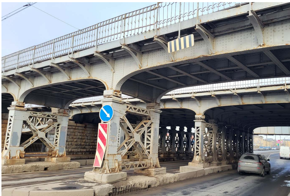
Фото 20. Объект культурного наследия регионального значения «Царскосельский железнодорожный мост», расположенный по адресу: город Санкт-Петербург, Витебское направление ж/д, "мост через Обводный кан.", лит. А, Б Дата съемки:15.02.2023
