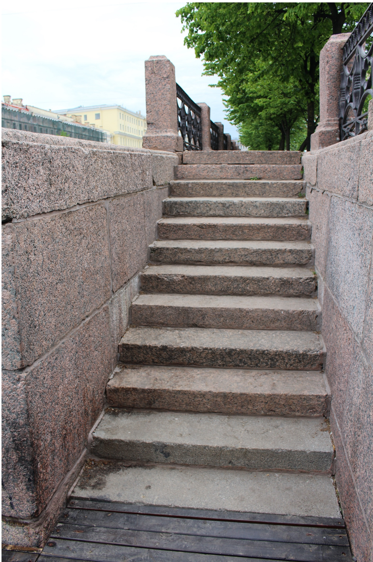
Фото 6. Вид на лестницу и нижнюю площадку спуска № 15 объекта культурного наследия федерального значения «Набережные со спусками».
