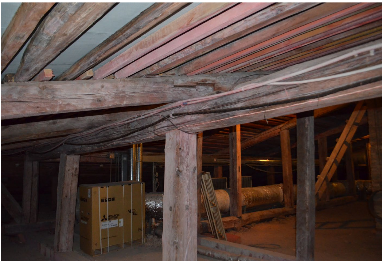
Фото 14. ОКН федерального значения «Кавальер Анны Иоанновны». Чердак. Стропильная система. Фрагмент. Съёмка 24.07.2023 г.
