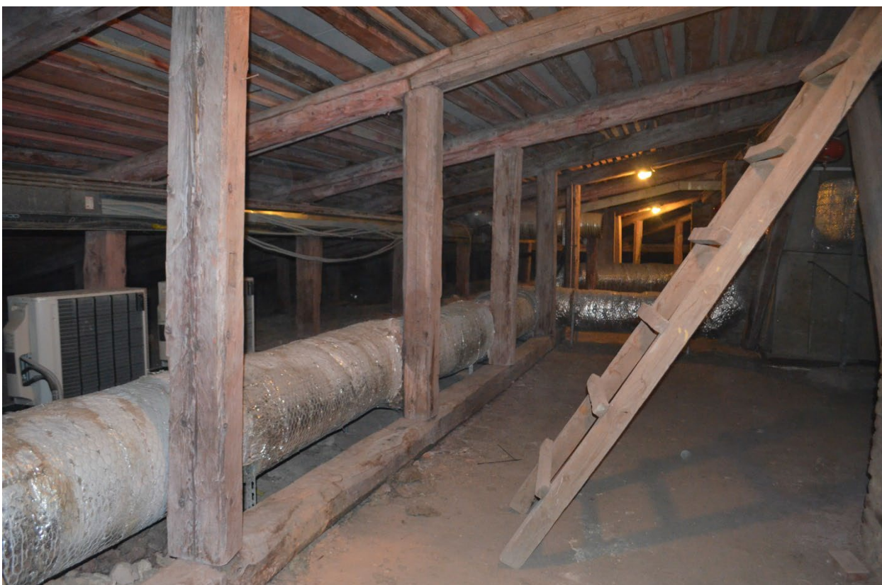
Фото 13. ОКН федерального значения «Кавальер Анны Иоанновны». Чердак. Стропильная система. Фрагмент. Съёмка 24.07.2023 г.
