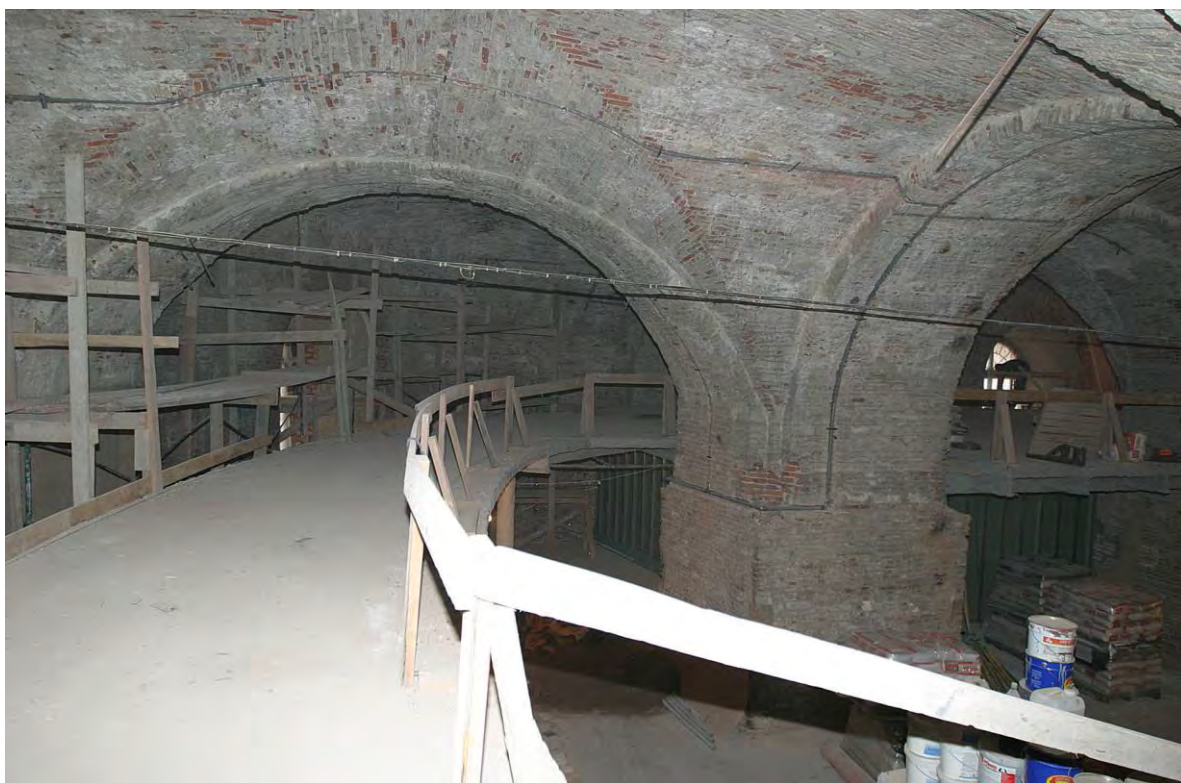
Илл.56. Фотография 2010 г. Работы по устройству антресольного этажа в помещении Кавальера Анны Иоанновны. КГИОП.
