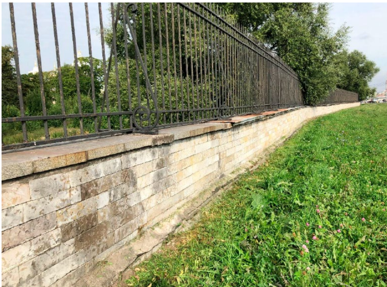
2. Ограждение объекта культурного наследия федерального значения «Кладбище Никольское», расположенного по адресу: г. Санкт-Петербург, Никольское кладбище, участок 1, входящего в состав объекта культурного наследия федерального значения «Александровская Лавра». 19.06.2023
