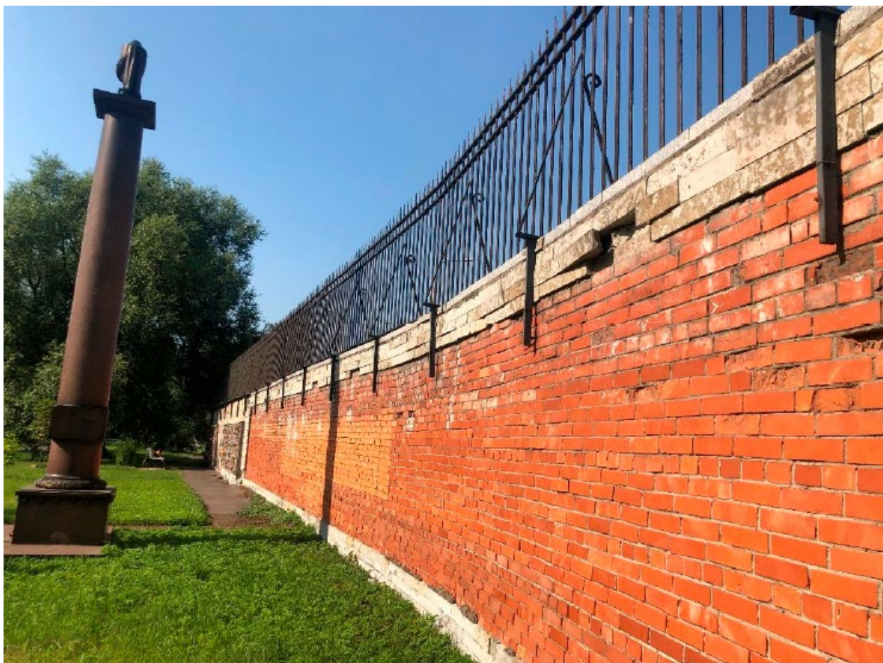
4. Стена колумбария объекта культурного наследия федерального значения «Кладбище Никольское», расположенного по адресу: г. Санкт-Петербург, Никольское кладбище, участок 1, входящего в состав объекта культурного наследия федерального значения «Александрo-Невская Лавра». 19.06.2023
