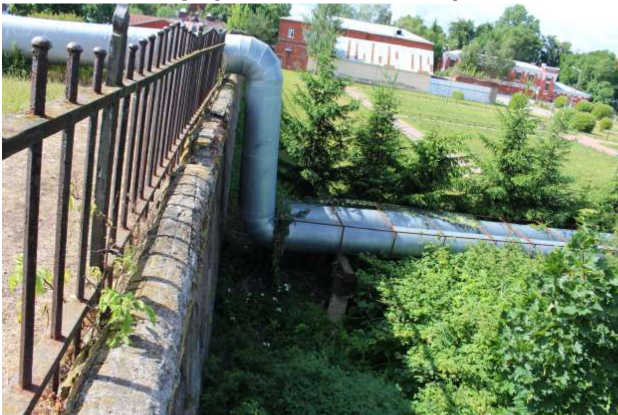
Фото 10. Вид на надземные трубы теплосети, проходящие в центральной части объектов культурного наследия федерального значения «Стена эскарповая» и «Вал земляной Главный».
