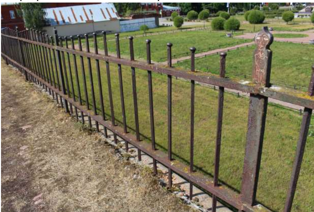
Фото 18. Вид на металлическое ограждение, проходящее по верхней части объекта культурного наследия федерального значения «Стена эскарповая».
