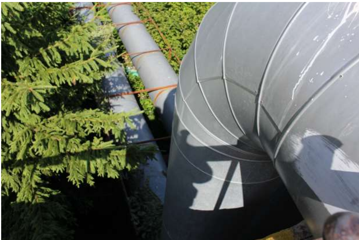
Фото 16. Вид на надземные трубы теплосети, проходящие в центральной части объектов культурного наследия федерального значения «Стена эскарповая» и «Вал земляной Главный».
