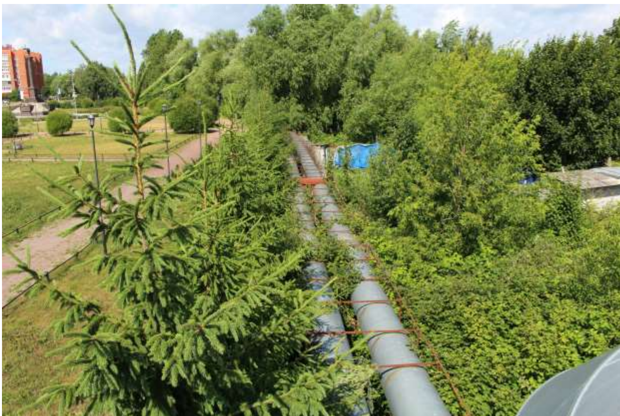
Фото 17. Вид на трубы теплосети к западу от объектов культурного наследия федерального значения «Стена эскарповая» и «Вал земляной Главный».
