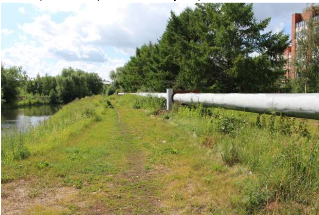
Фото 37. Вид на береговой откос объекта культурного наследия федерального значения «Ров крепостной оборонительный» к югу от Кронштадтского шоссе.
