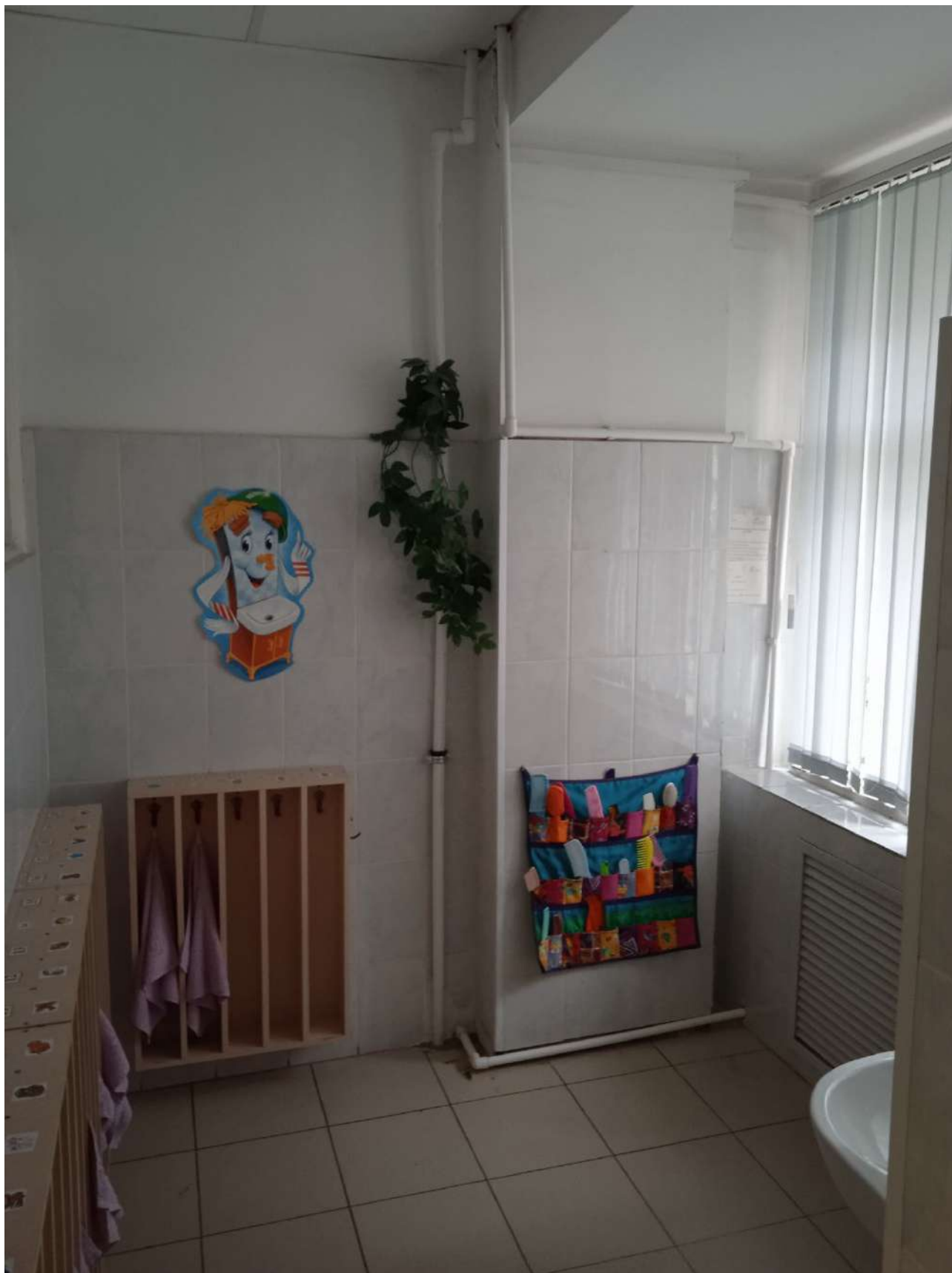
Фото 14. Помещение 4. Санузел. Следы протечек на подвесном потолке.
