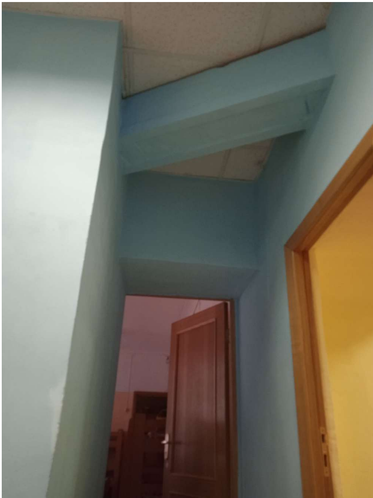
Фото 17. Помещение 2. (справа вход в пом. 18) Вентиляционный короб
