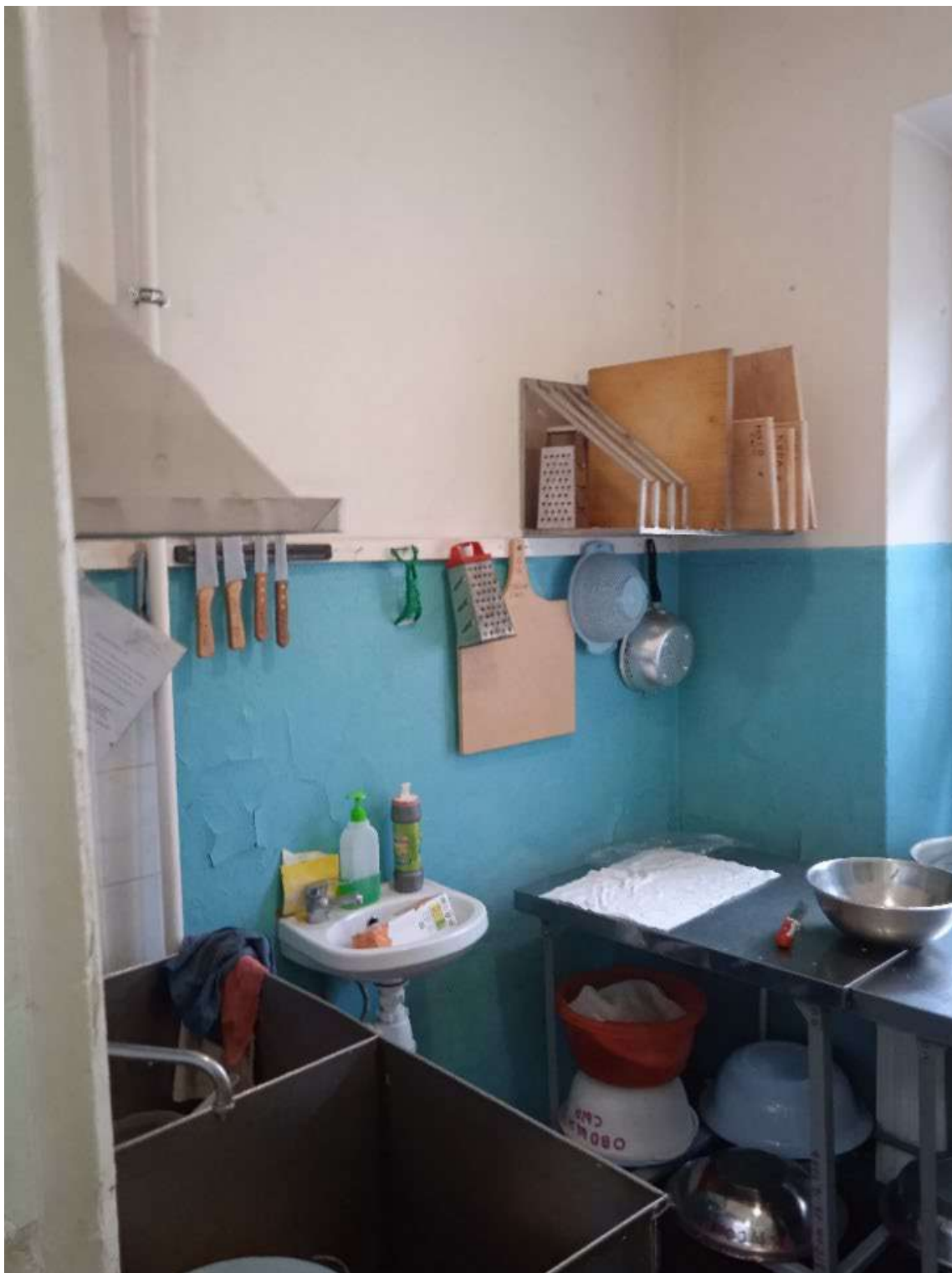
Фото 36. Помещение 12. Моечная. Деструкция штукатурки, шелушение и отслоение окрасочных слоев.
