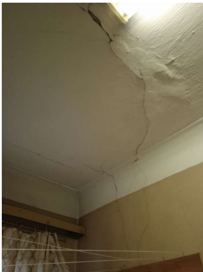
Фото 40 Помещение 14 Постирочная. Трещины по потолку и перегородке
