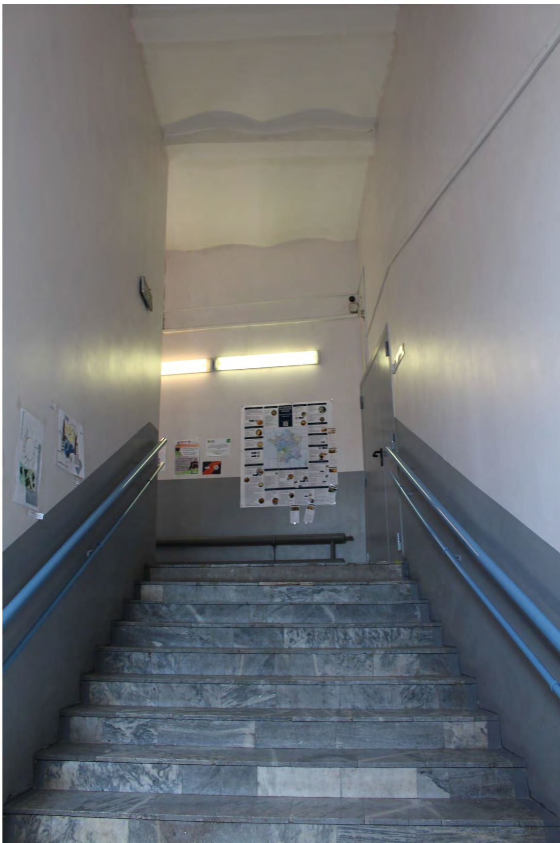
Фото 41. Вид на северо-восточную лестничную клетку лицевого корпуса выявленного объекта культурного наследия «Манеж и конюшни лейб-гвардии Гренадерского полка (здание тира лейб-гвардии Стрелкового батальона)». Фото 22.05.2023 г.
