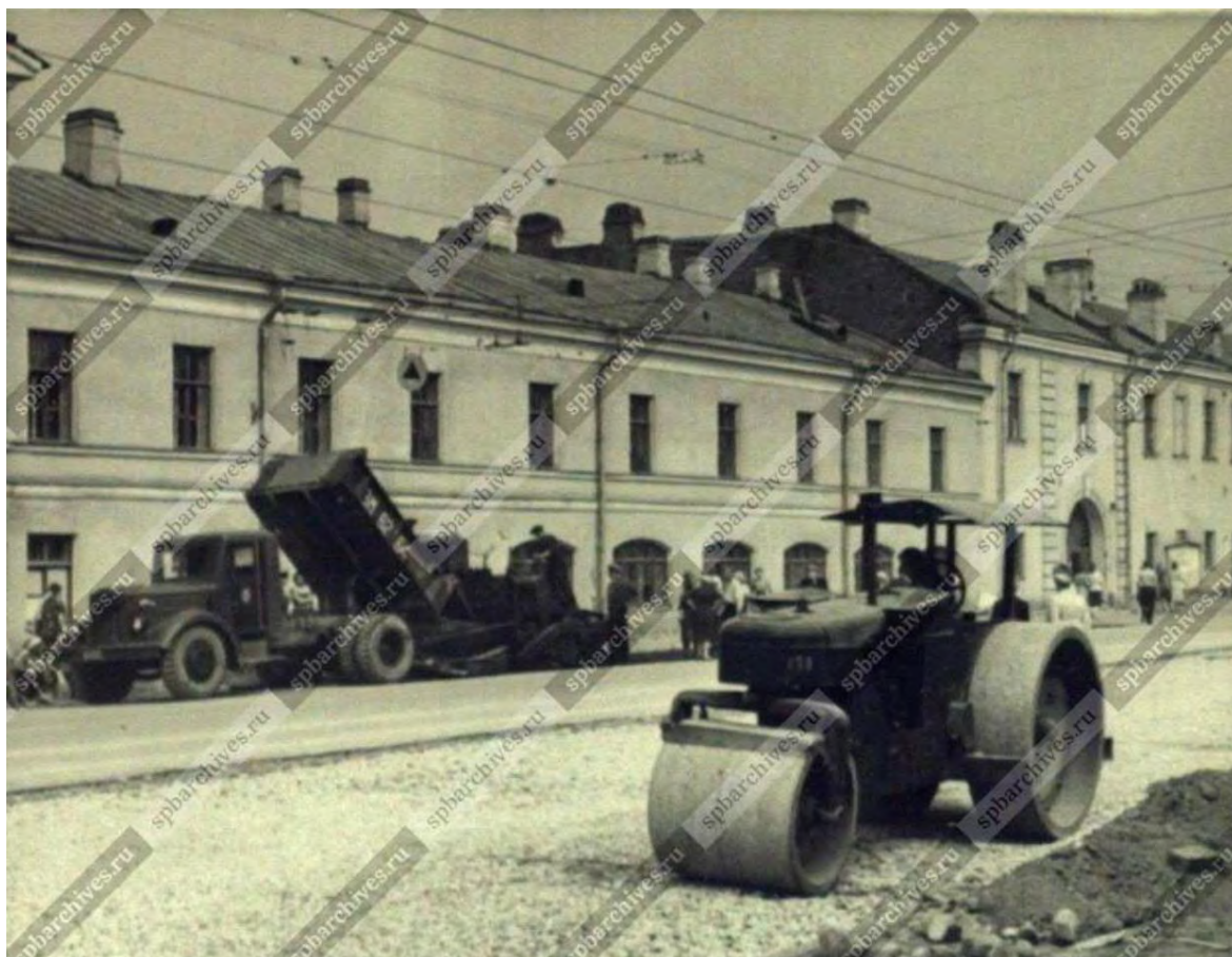
Илл. 34. Укладка асфальта на Загородном проспекте. 20.08.1955 г. (источник: ЦГАКФФД СПб. Фотодокумент Бр 12193).
