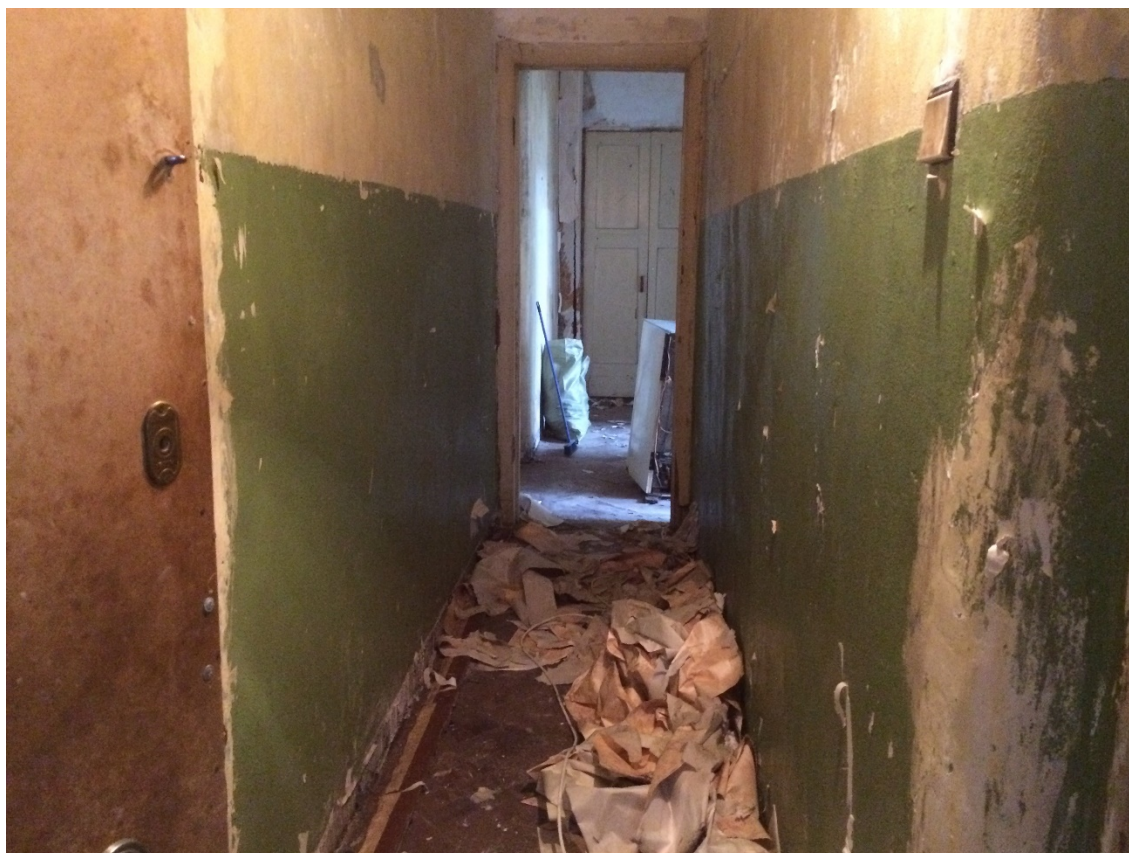
Фото 23 Общий вид на часть помещений квартиры № 50 (№ 9 по плану ПИБ). Наблюдается складирование строительного мусора.
