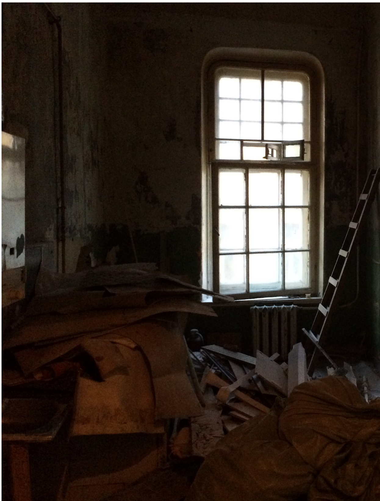
Фото 14 Общий вид на часть помещений квартиры № 50 (№ 6 по плану ПИБ). Наблюдается складирование строительного мусора.
