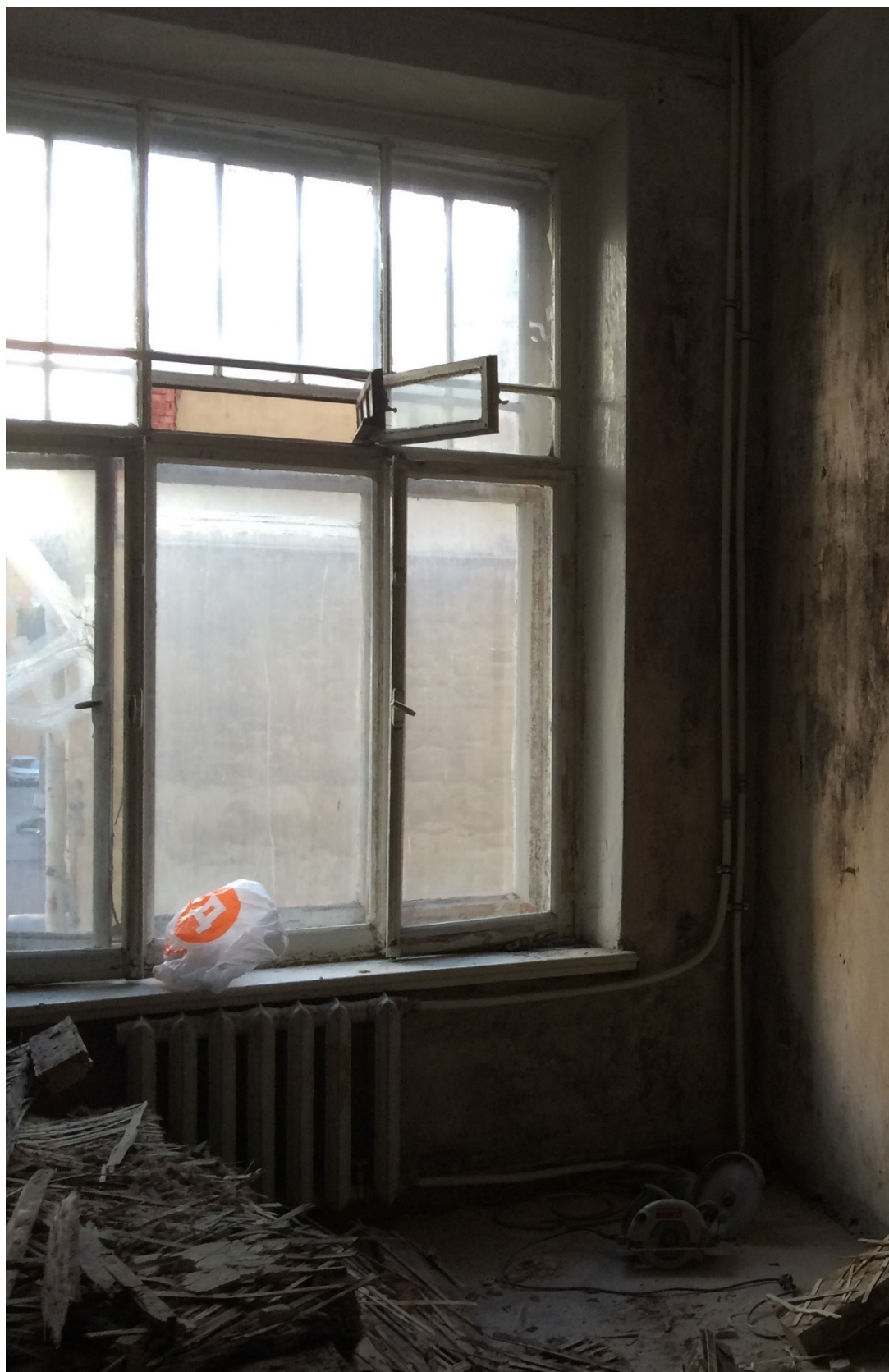
Фото 19 Общий вид на часть помещений квартиры № 50 (№ 8 по плану ПИБ). Наблюдается складирование строительного мусора.
