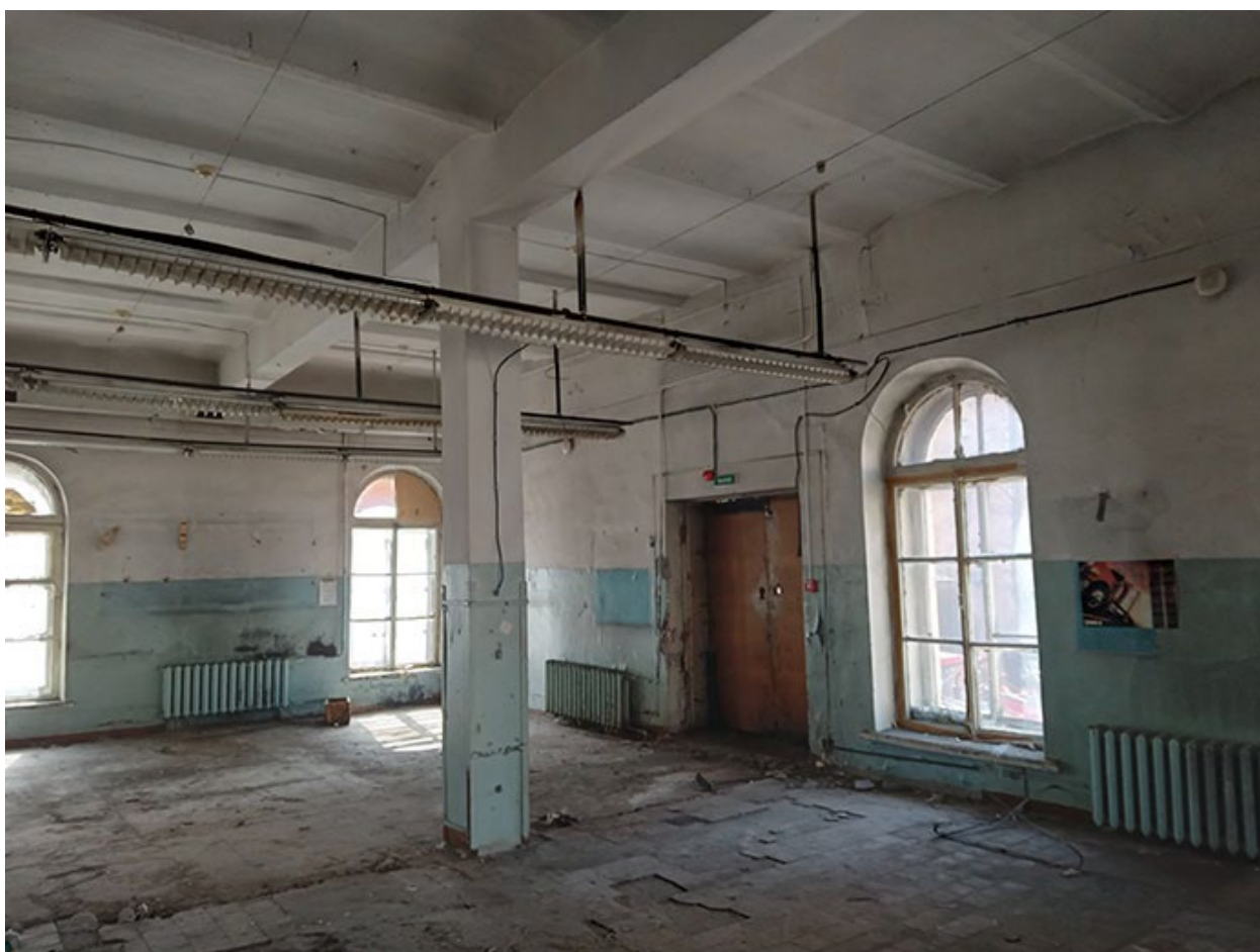
Фото 67. Выявленный объект культурного наследия «Здание детского приюта вел. кн. Александры Николаевны (со служебными постройками)» по адресу: г. Санкт-Петербург, Лермонтовский пр. 51, 12-я Красноармейская б/№
