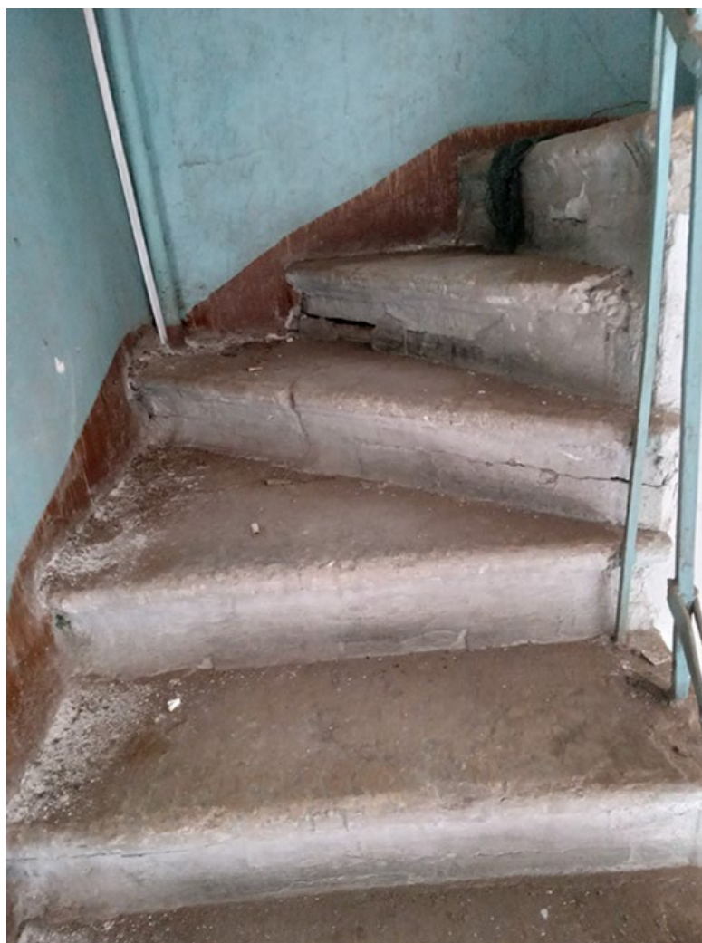
Фото 50. Выявленный объект культурного наследия «Здание детского приюта вел. кн. Александры Николаевны (со служебными постройками)» по адресу: г. Санкт-Петербург, Лермонтовский пр. 51, 12-я Красноармейская б/№
