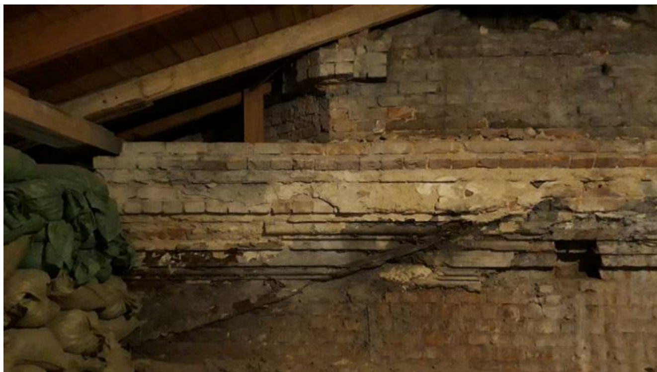
Фото 19. Объект культурного наследия регионального значения «Подворье Старо-Афонского Свято-Андреевского мужского скита» по адресу: Санкт-Петербург, 5-я Советская ул., д. 31-33, лит. А — церковь Благовещения Пресвятой Богородицы. Пространство чердака (надстроенный третий этаж). Вид на центральный восьмимерик с сохранившимися фрагментами венчающего карниза. Сохранилось гнездо коньковой балки и скат кровли.
