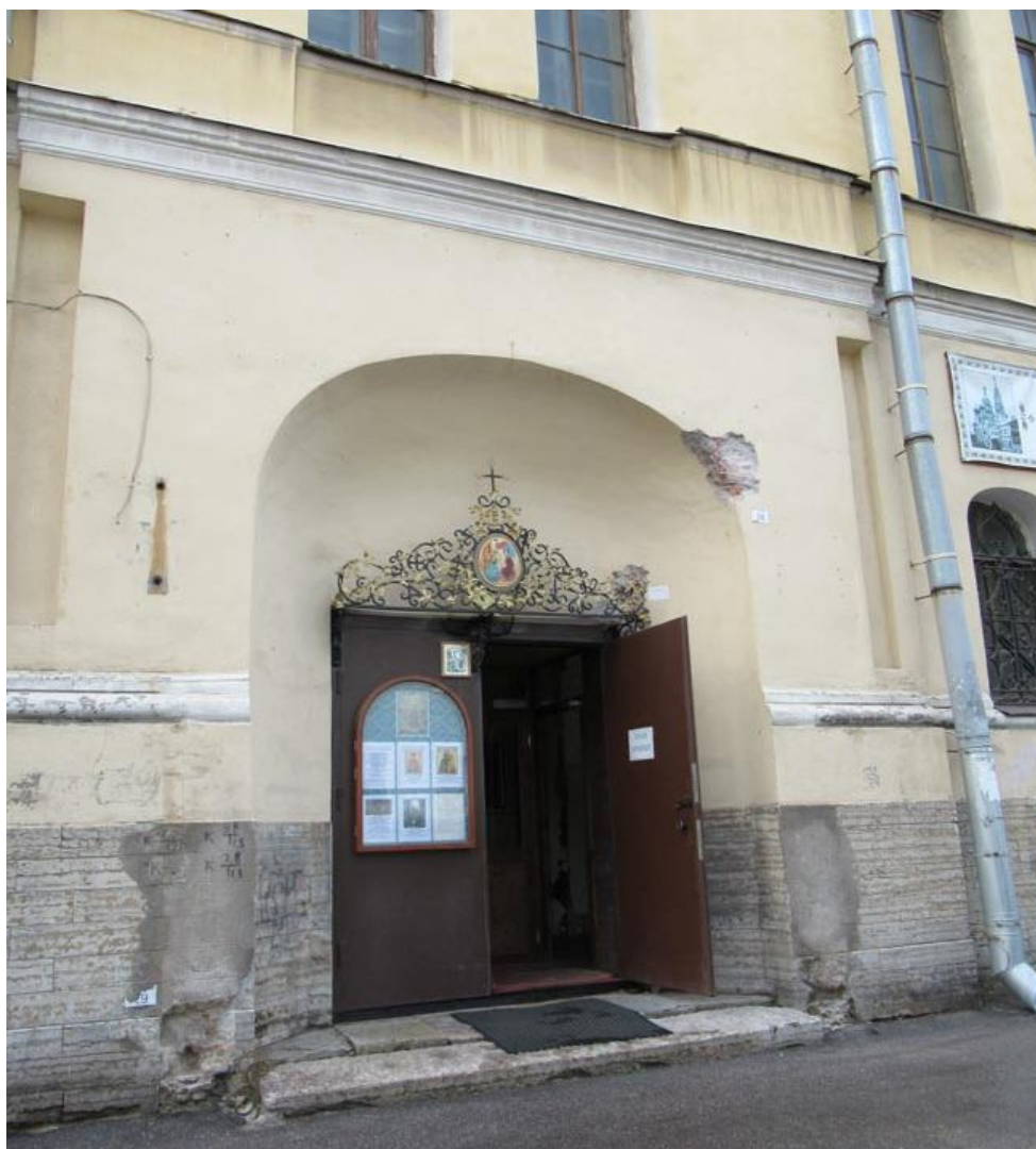
Фото 11. Объект культурного наследия регионального значения «Подворье Старо-Афонского Свято-Андреевского мужского скита» по адресу: Санкт-Петербург, 5-я Советская ул., д. 31-33, лит. А — церковь Благовещения Пресвятой Богородицы. Главный вход с 5-й Советской улицы в полукруглой нише с конхой.
