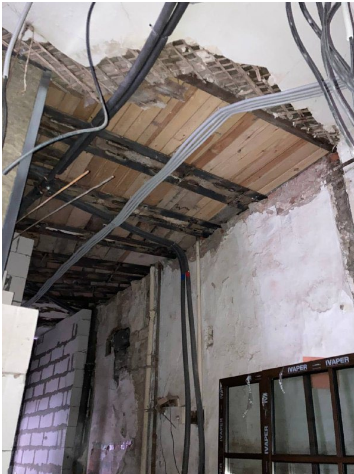
Фото 3. Вид на потолок коридора и несущую стену.
