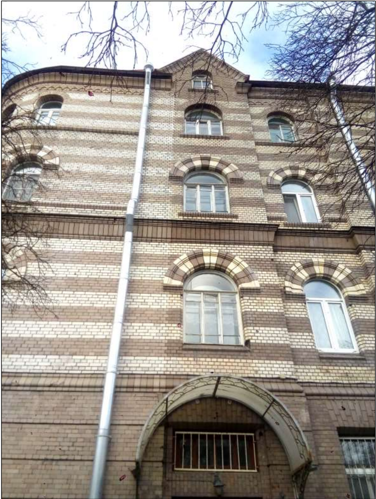
9. Центральная часть фасада. Видна разница в цвете облицовочных кирпичей и вертикальный шов. Фото Н.М.Петуховой. 01.02.2021г.
