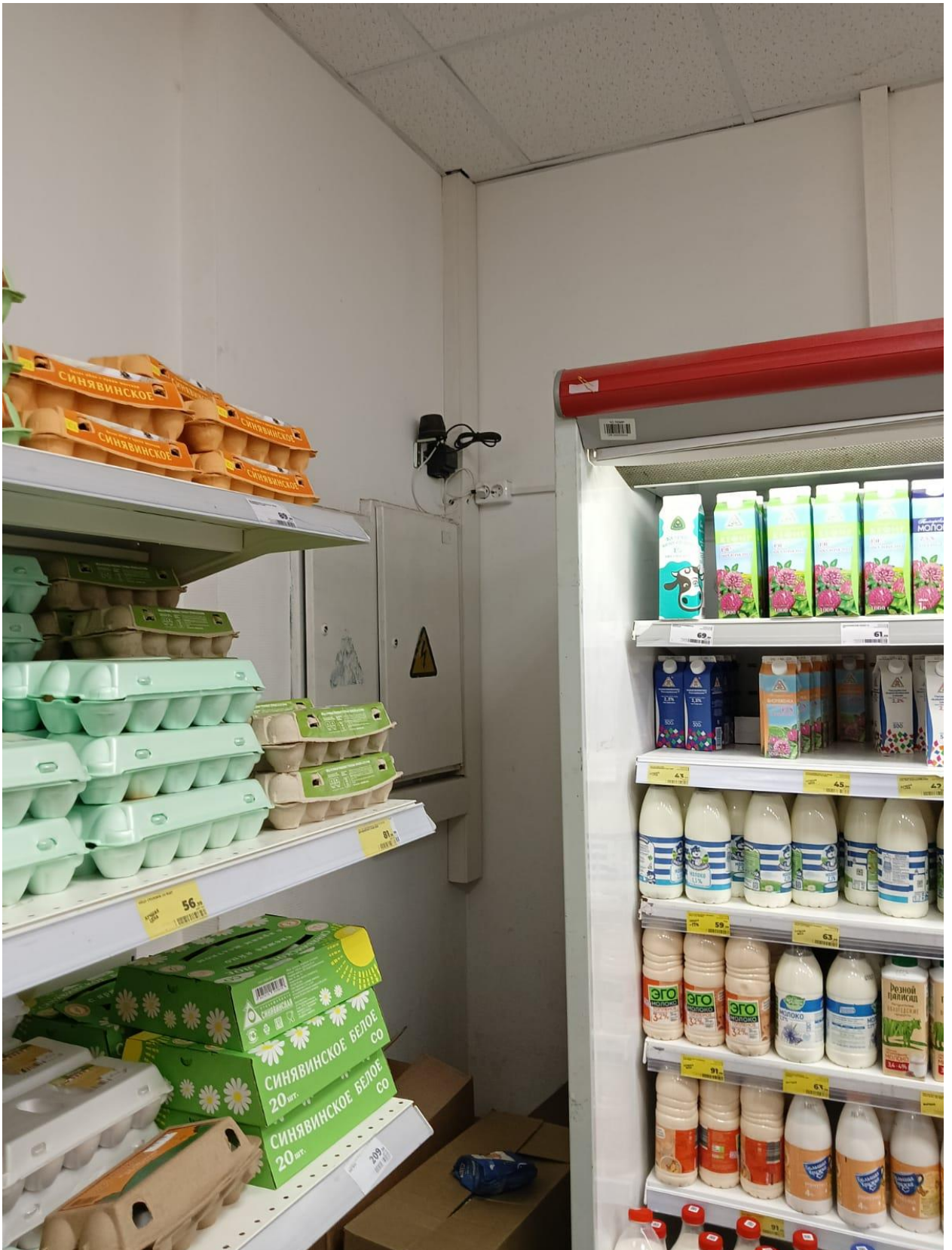
Фото 11. Объект культурного наследия регионального значения «Жилой дом купца Синебрюхова», расположенный по адресу: Санкт-Петербург, город Кронштадт, улица Аммермана, дом 26, литера А. Помещение 2-Н, торговый зал, электрощит.
