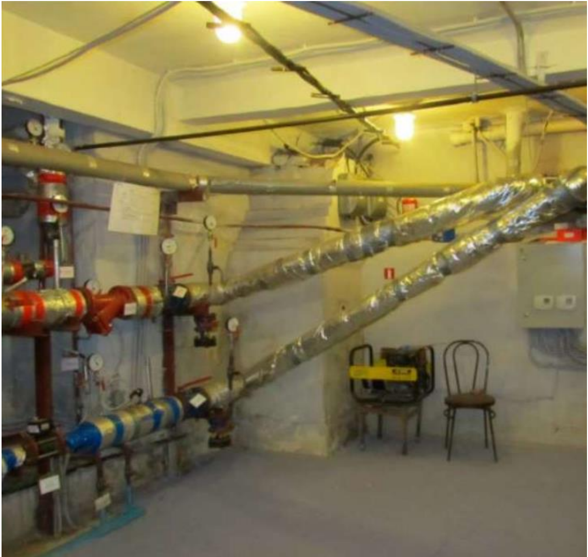
28. Выявленный объект культурного наследия «Дом культуры им. В. И. Ленина завода «Большевик», 1927–1929 гг., г. Санкт-Петербург, проспект Обуховской Обороны, 223, литера А. Соединение труб теплосети с узлами учета.
