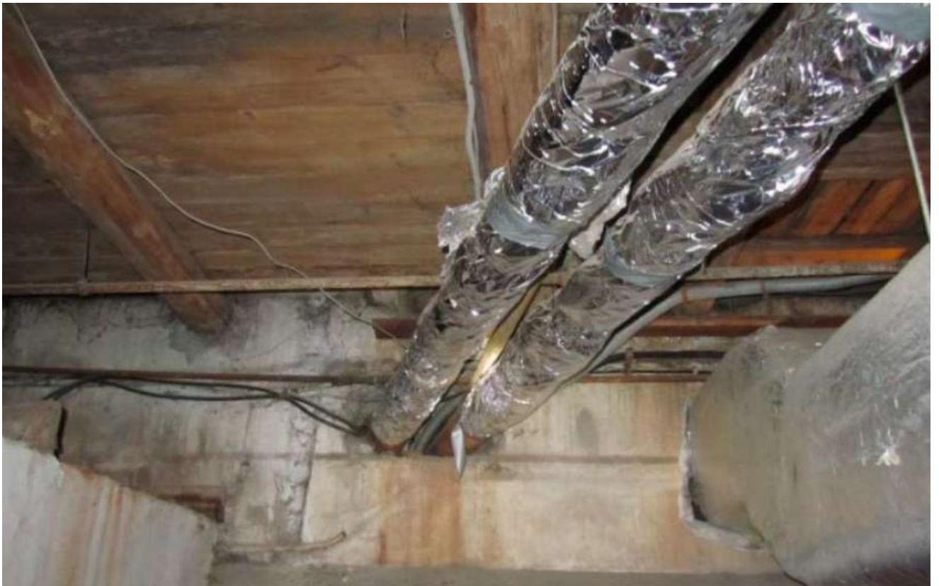
26. Выявленный объект культурного наследия «Дом культуры им. В. И. Ленина завода «Большевик», 1927–1929 гг., г. Санкт-Петербург, проспект Обуховской Обороны, 223, литера А. Места примыкания труб теплосети.
