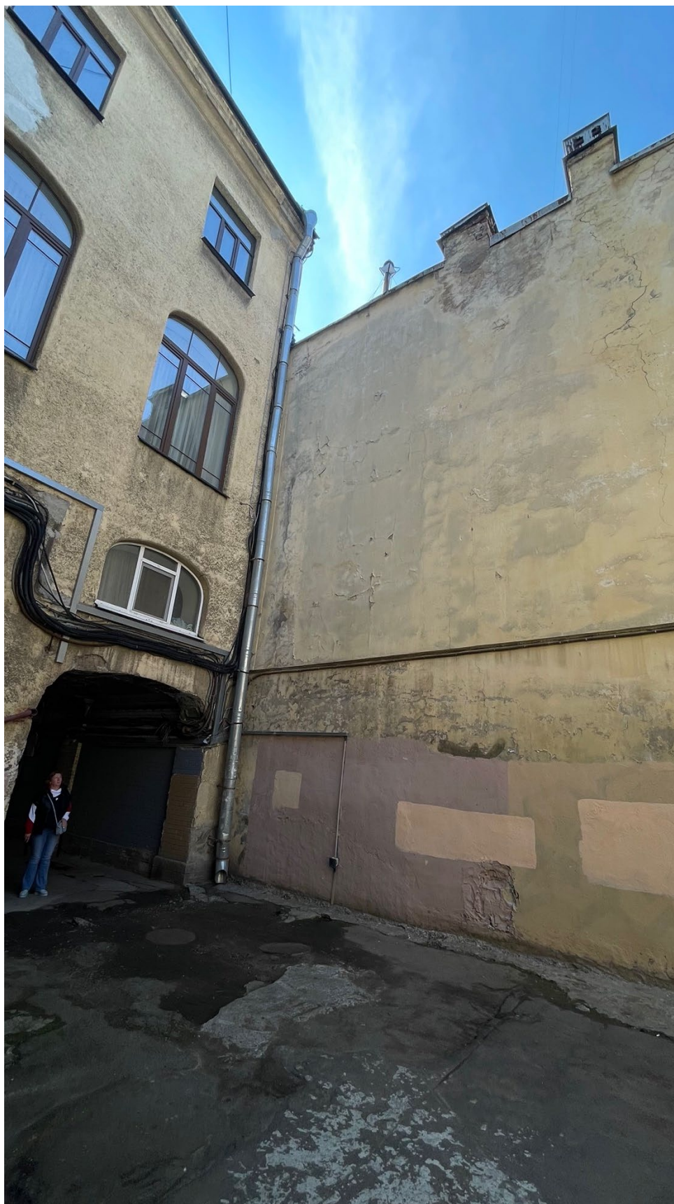
14. Вид на дворовой фасад объекта культурного наследия регионального значения «Особняк А.Нейдгарта. 1910 г. Гр.инж.И.И.Бургазлиев» по адресу: Кирочная улица, дом 40, литера А (Салтыкова-Щедрина, 40) и брандмауэрную стену дома №38Б;
