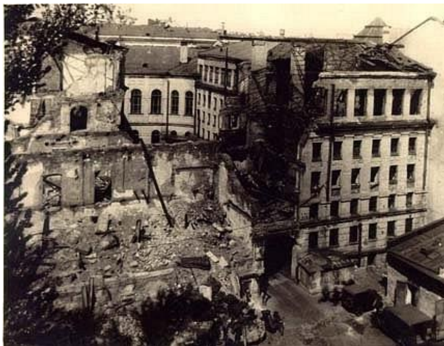
26. Главное Казначейство. Разрушения от попадания в здание бомбы в годы блокады Ленинграда. Фотография. www.citywalls.ru .
