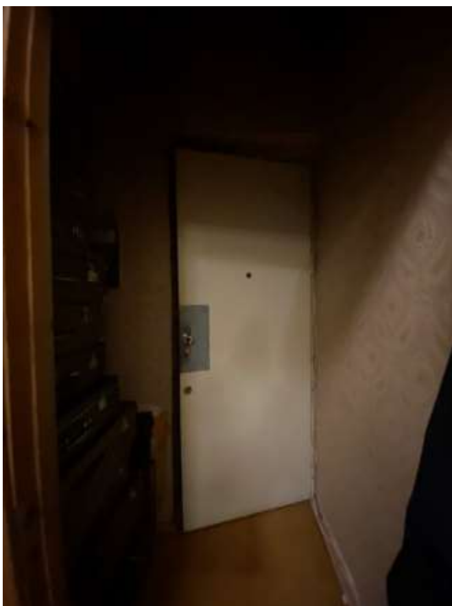
Фото 7. Помещение № 1 (экспликация помещений указана в соответствии с техническим паспортом от 12.08.2012 г.). Коридор (тамбур). Вид с юго-востока.
