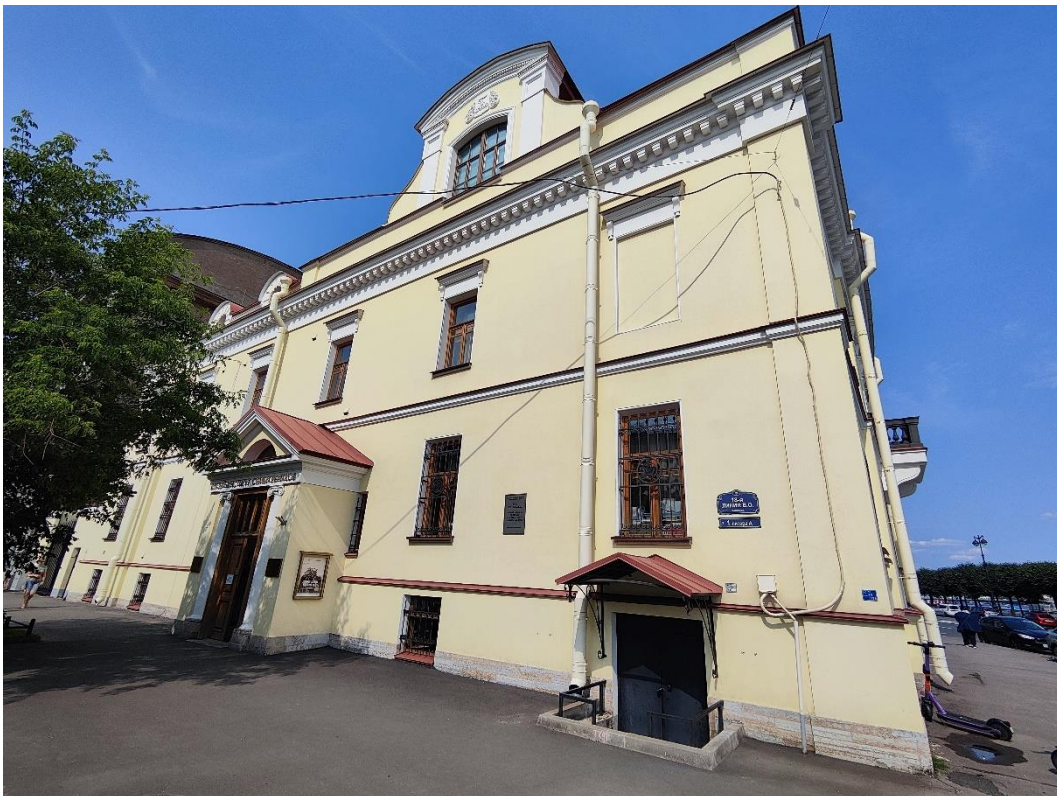
2. «Дом Боткина М.П.», ул. 18-я линия В.О., д.1, лит. А. Юго-западный фасад. Общий вид. Фото 22.06.2023г.
