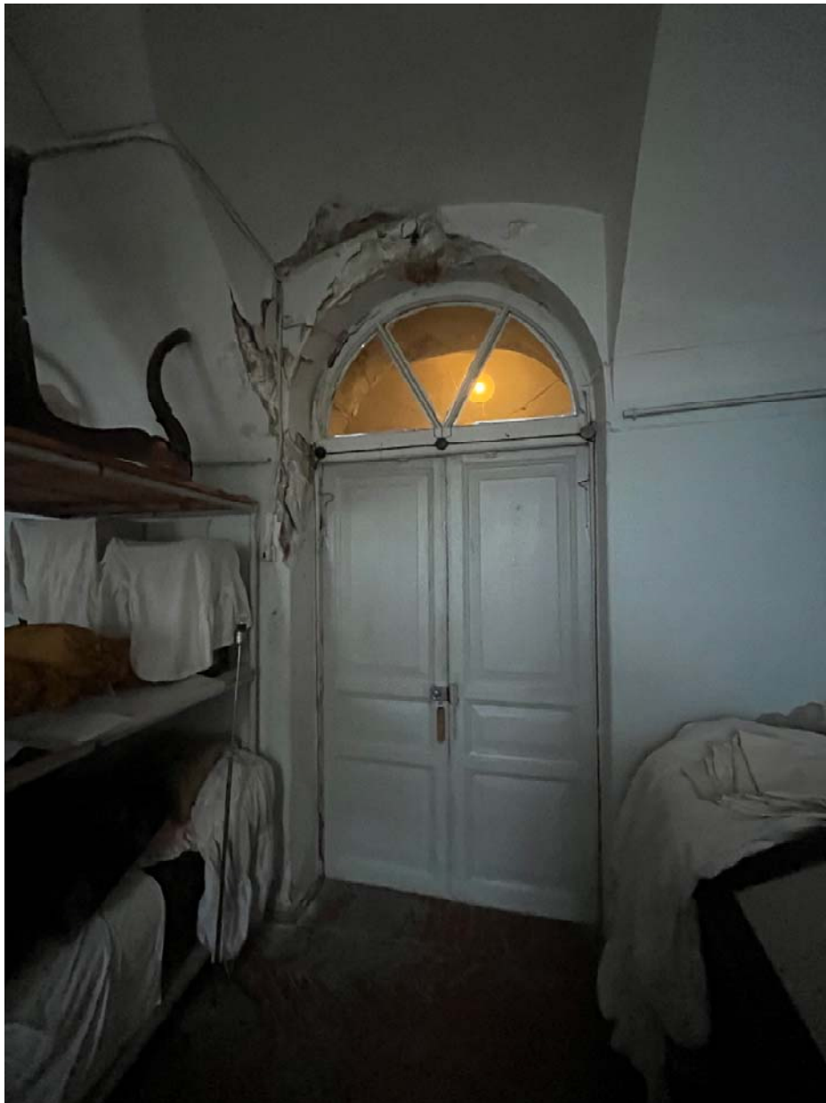
Фото №33. 1-ый этаж, восточное крыло, помещение 1-Н(4), деструкция материалов отделки.
