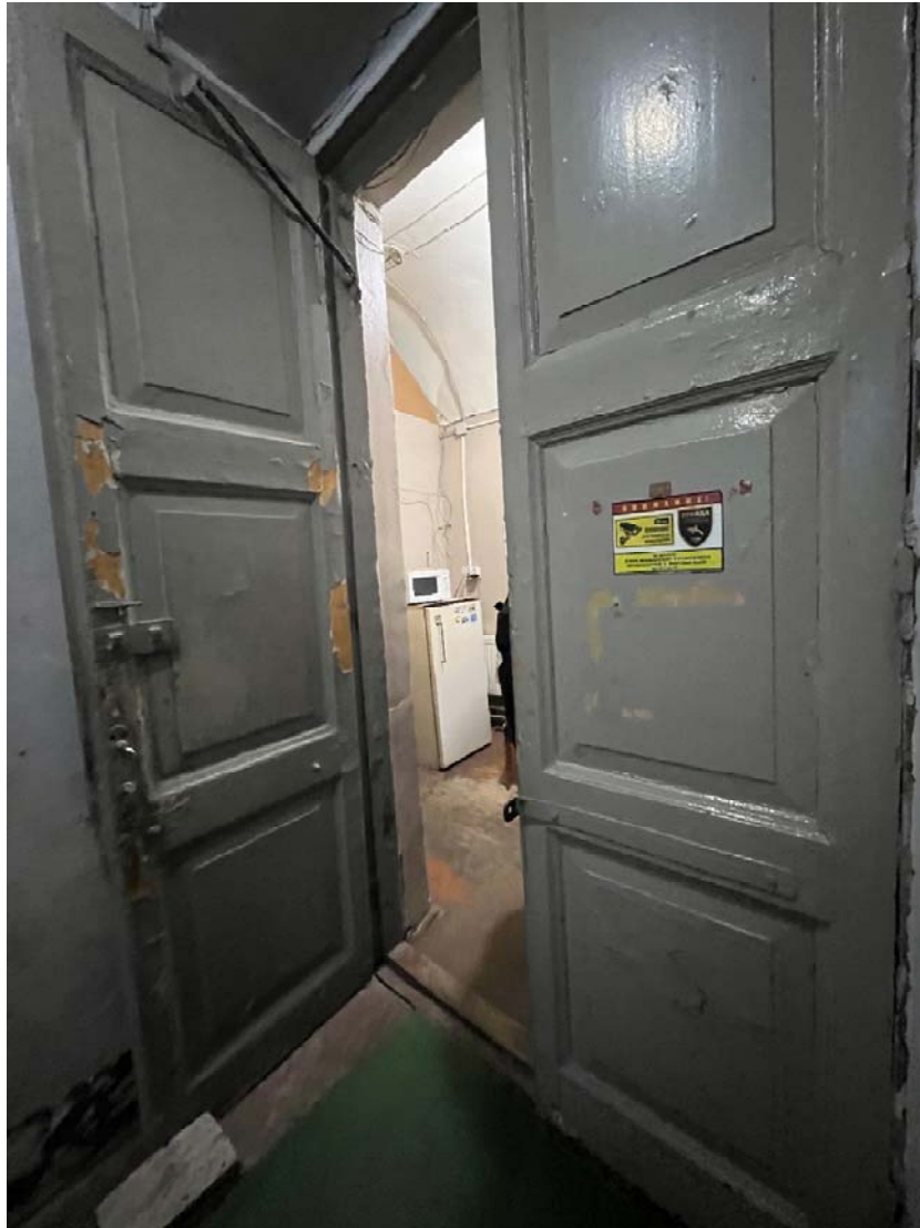
Фото №25. 1-ый этаж, помещение 1-Н, лестничная клетка, дверное заполнение входа в помещения восточного крыла.
