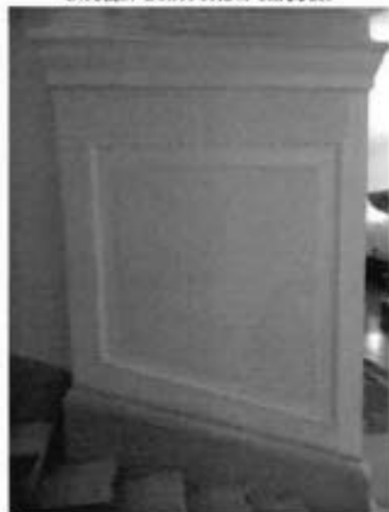
35. Штукатурные зеркала в лепных рамах с прорезкой растительного орнамента на пилонах парадной лестницы.
