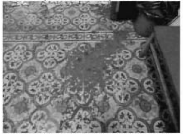
11. Деструкция глазурованного покрытия метлахской плитки в вестибюле парадного входа
