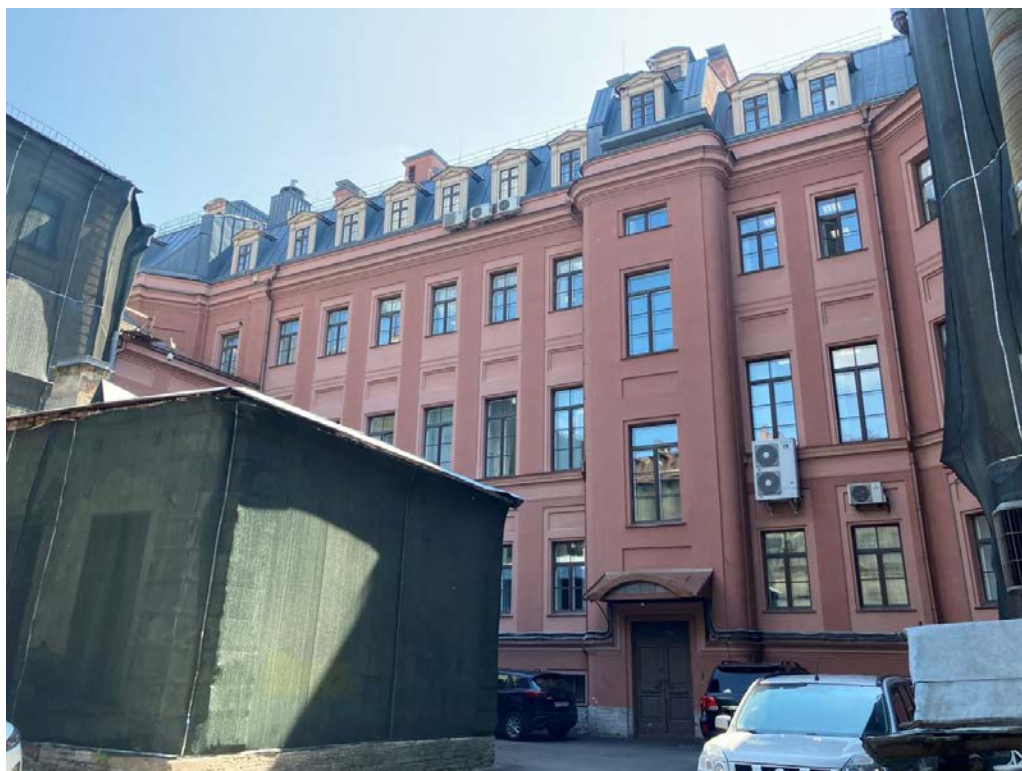
Фото 17. Фрагмент дворового фасада объекта культурного наследия регионального значения «Дом Утина И. Здесь с 1860 г. жил и в 1911 г. умер историк, издатель журнала "Вестник Европы" Стасюлевич Михаил Матвеевич. Здесь с 1893 г. жил и в 1895 г. умер ученый-машиностроитель Вышнеградский Иван Алексеевич. Здесь в 1884-1888 гг. останавливался скульптор Антокольский Марк Матвеевич»
