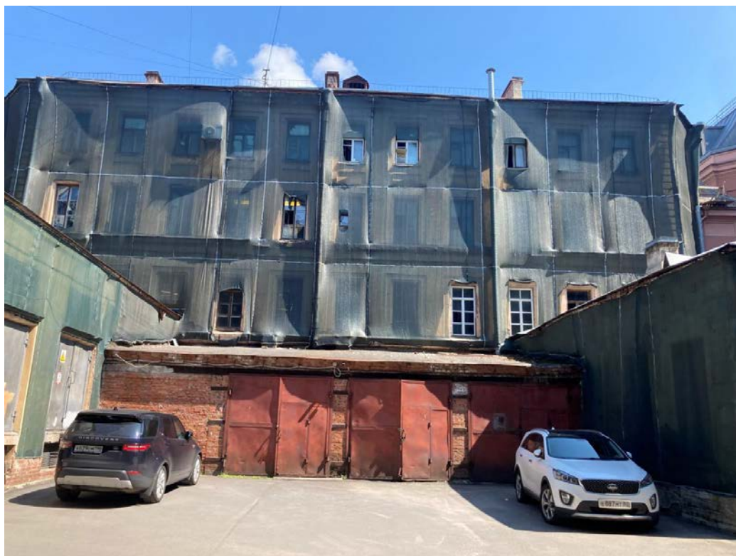
Фото 15. Фрагмент дворового фасада объекта культурного наследия регионального значения «Дом Утина И. Здесь с 1860 г. жил и в 1911 г. умер историк, издатель журнала "Вестник Европы" Стасюлевич Михаил Матвеевич. Здесь с 1893 г. жил и в 1895 г. умер ученый-машиностроитель Вышнеградский Иван Алексеевич. Здесь в 1884-1888 гг. останавливался скульптор Антокольский Марк Матвеевич»
