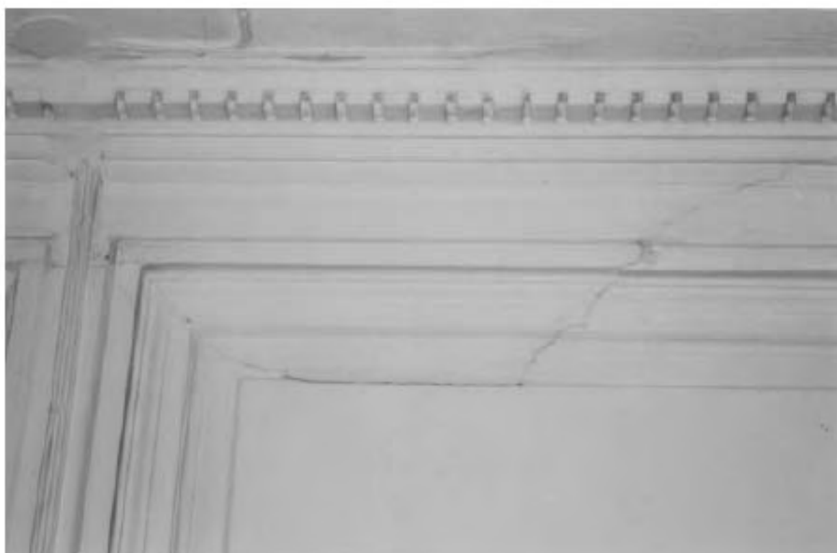
81. Фрагмент штукатурно-лепного декора парадной лестницы. 2002 г. // ООО «Капитал-Строй». Проект реконструкции учебного корпуса детского дома-школы № 51. Том 1. Книга 1. Часть 1. Альбом фотоплюстраций № 1. Дефекты и общие виды фасадов здания. СПб., 2002. С. 26. / КГИОП. П. 1500Б/Пр. 79.
