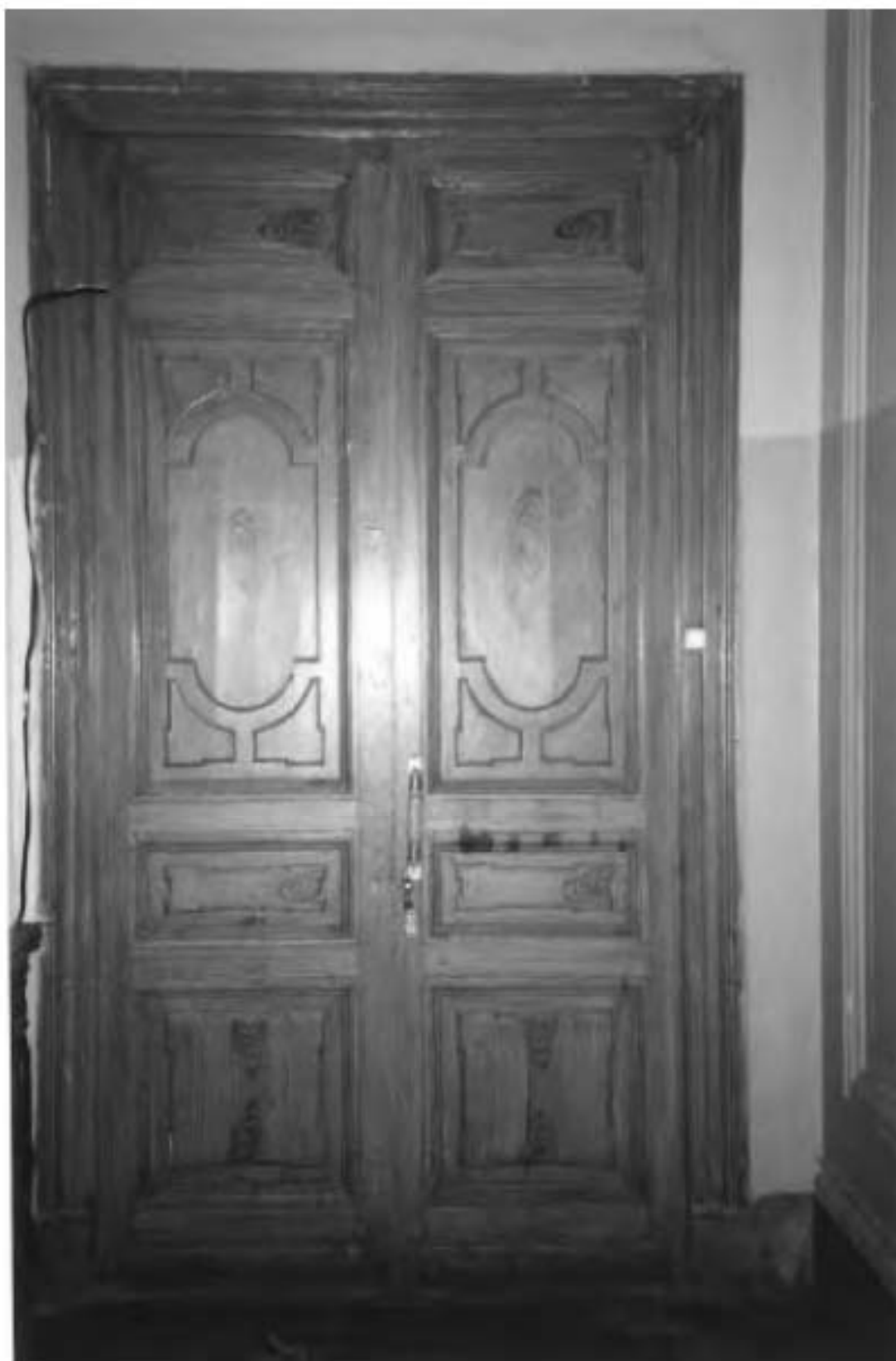
78. Общий вид заполнения дверных проемов парадной лестницы. 2002 г. // ООО «Капитал-Строй». Проект реконструкции учебного корпуса детского дома-школы № 51. Том 1. Книга 1. Часть 1. Альбом фотоиллюстраций № 1. Дефекты и общие виды фасадов здания. СПб., 2002. С. 19. / КТИОП. П. 1500Б/Пр. 79.
