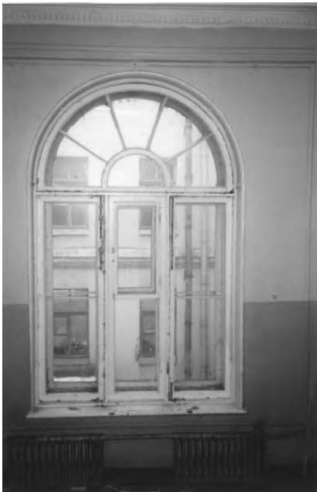
77. Общий вид заполнения оконного проема парадной лестницы. 2002 г. // ООО «Капитал-Строй». Проект реконструкции учебного корпуса детского дома-школы № 51. Том 1. Книга 1. Часть 1. Альбом фотоиллюстраций № 1. Дефекты и общие виды фасадов здания. СПб., 2002. С. 17. / КТИОП. П. 1500Б/Пр. 79.
