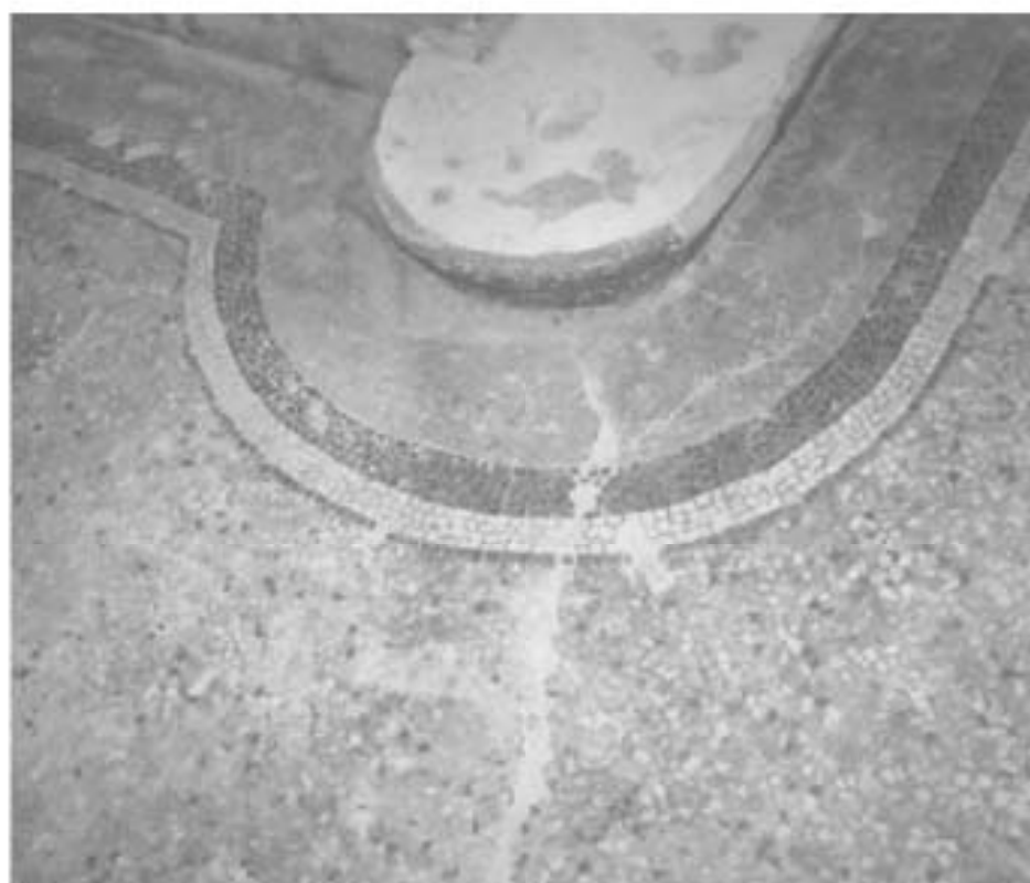
90. Рисунок мозаичного пола вестибюля 1 этажа. Фрагмент пола вдоль нижней ступени. 2005 г. // ООО «ПСО РЕСТАВРАТОР». Рисунок мозаичных полов передней лестницы по адресу: СПб., ул. Бакунина, д. 8 (по факту). СПб., 2005. С. 9. / КГИОП. 15006/Пр. 82.
