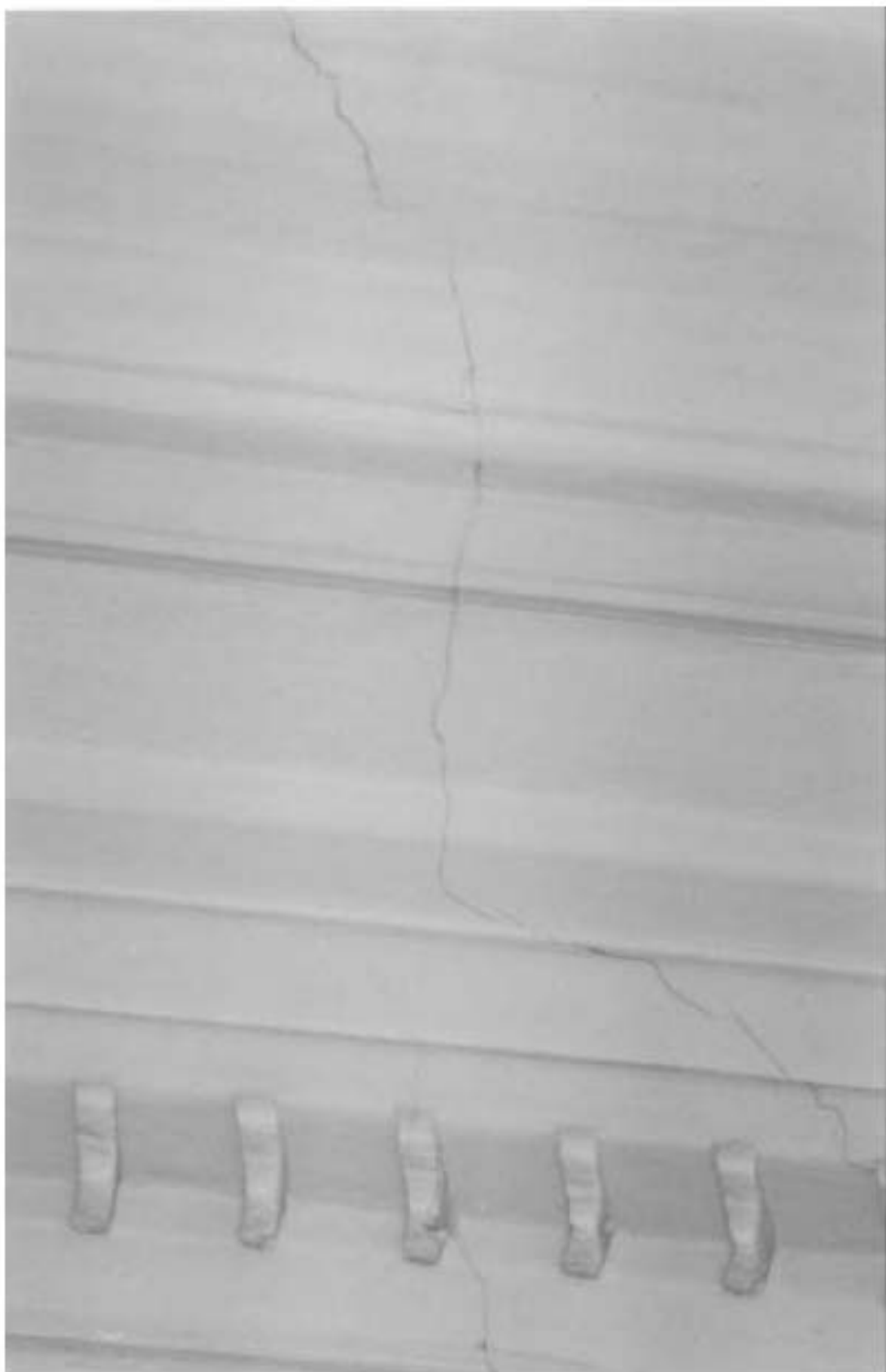
76. Фрагмент штукатурно-лепного декора фойе. 2002 г. // ООО «Капитал-Строй». Проект реконструкции учебного корпуса детского дома-школы № 51. Том 1. Книга 1. Часть 1. Альбом фотопубликаций № 1. Дефекты и общие виды фасадов здания. СПб., 2002. С. 13. / КГИОП. П. 1500Б/Пр. 79.
