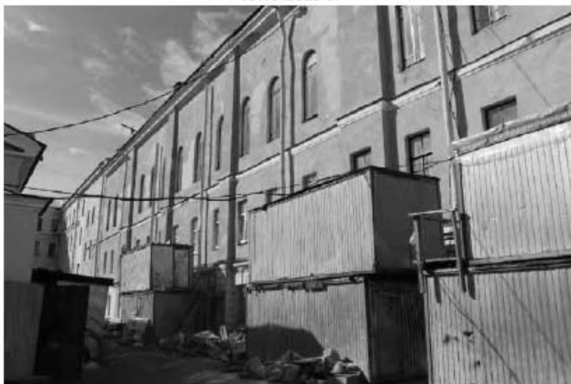
Фото 29. Вид на южный фасад северного корпуса выявленного объекта культурного наследия «Главный корпус с 1-м солдатским корпусом, офицерским флигелем и Михайловское артиллерийское училище». Фото 03.05.2023 г.
