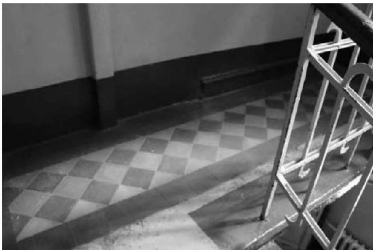
Фото 221. Выявленный объект культурного наследия «Баня». Лестница 2-Н. Фото 03.05.2023 г.
