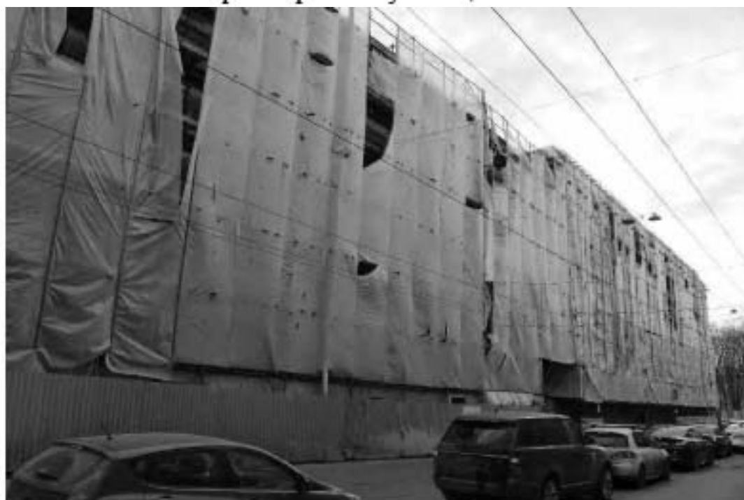
Фото 6. Вид на лицевые фасады выявленных объектов культурного наследия «Корпус квартир офицеров (угловой)» (объект культурного наследия регионального значения «Академия Михайловская артиллерийская, где преподавали ученые Ленц Э.Х., Остроградский М.В., Петрушевский В.Ф.»)), «Главный корпус с 1-м солдатским корпусом, офицерским флигелем и Михайловское артиллерийское училище». Фото 17.04.2023 г.
