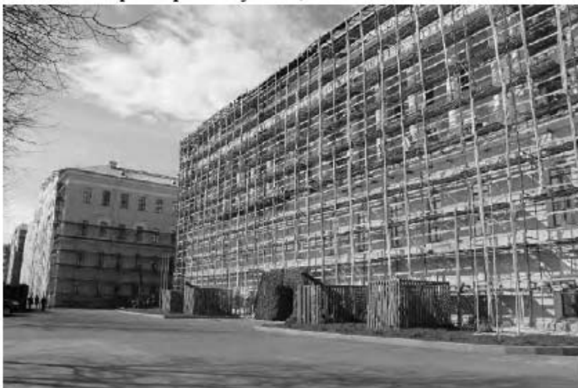
Фото 16. Вид на южный фасад южного корпуса выявленного объекта культурного наследия «Главный корпус с 1-м солдатским корпусом, офицерским флигелем и Михайловское артиллерийское училище». Фото 03.05.2023 г.
