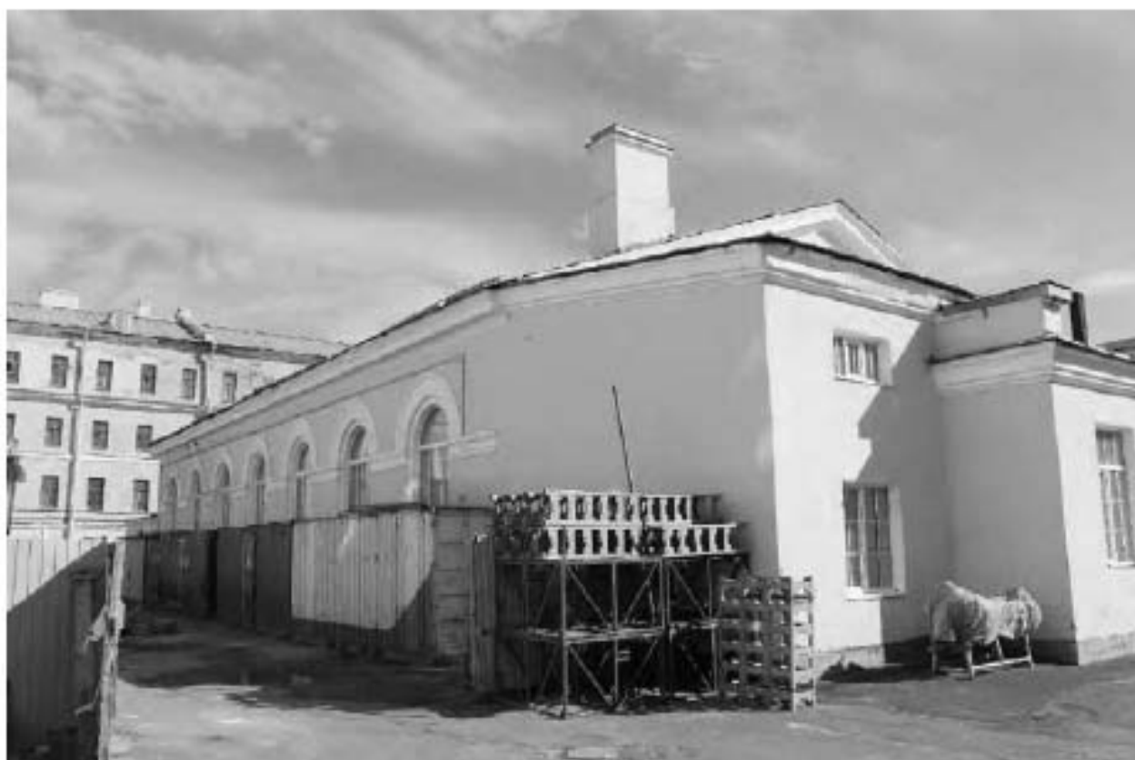
Фото 50. Вид на северный фасад выявленного объекта культурного наследия «Малый манеж». Фото 03.05.2023 г.
