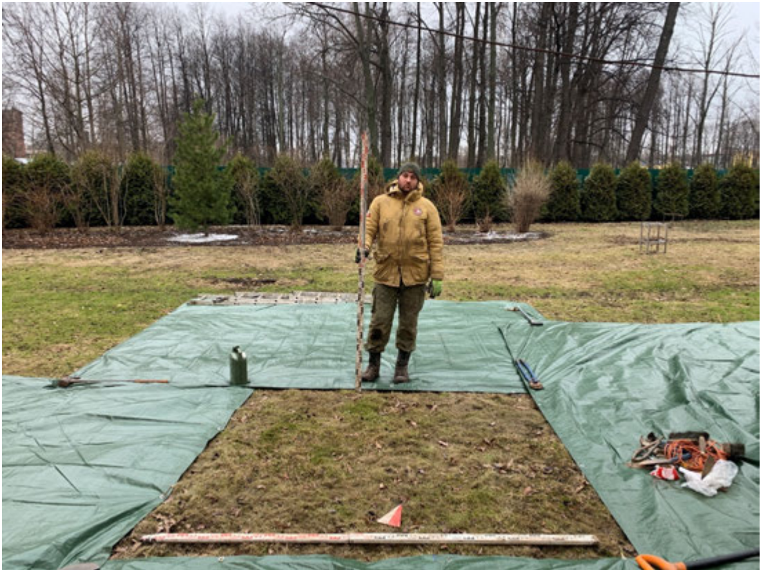
Рис. 36. СПб, Духовная семинария-2023. Дом 15-17. Местоположение шурфа 1 до начала работ, вид на северо-запад.
