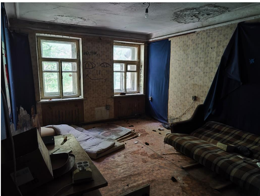
25. «Дом Утеман Ф.Ф.», наб. Лейтенанта Шмидта д. 31, лит. 3. Помещение второго этажа. Общий вид. Фото 08.06.2023г.
