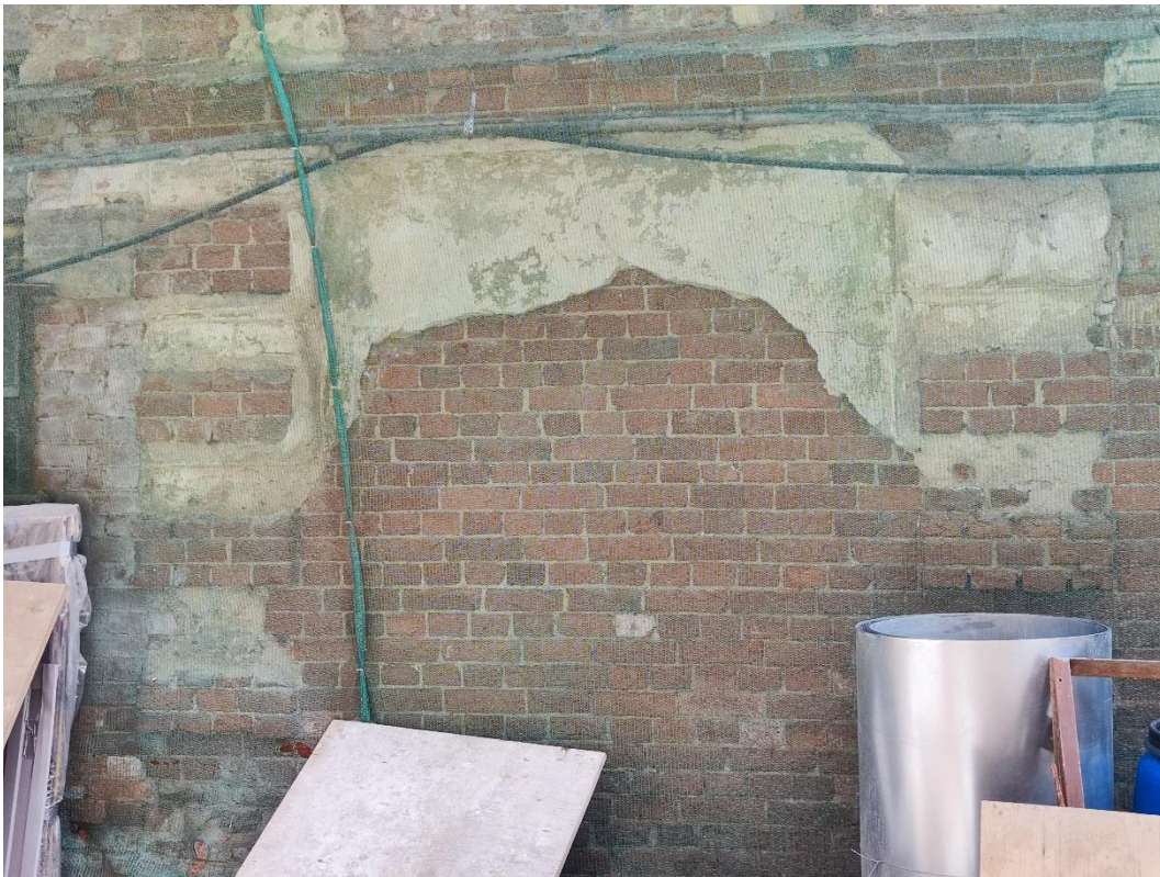
7. «Дом Уteman Ф.Ф.», наб. Лейтенанта Шмидта д. 31, лит. 3. Юго-западный фасад. Фрагмент. Фото 08.06.2023г.
