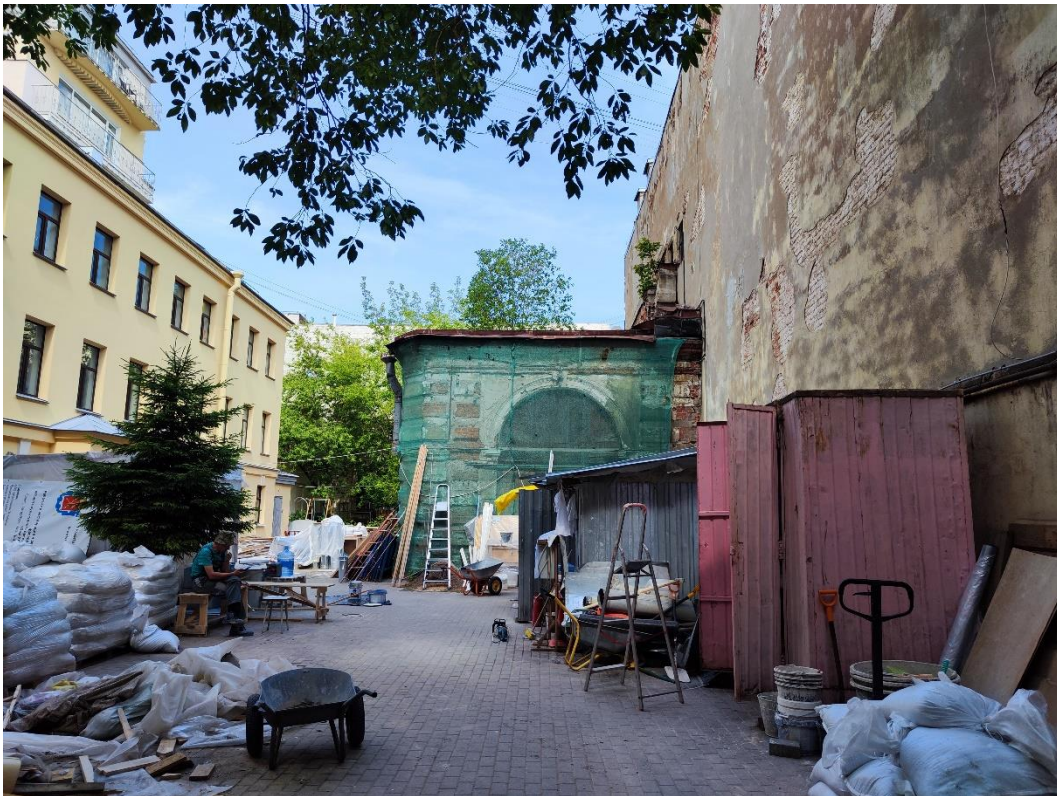
1. «Дом Утеман Ф.Ф.», наб. Лейтенанта Шмидта д. 31, лит. 3. Юго-восточный фасад. Общий вид. Фото 08.06.2023г.
